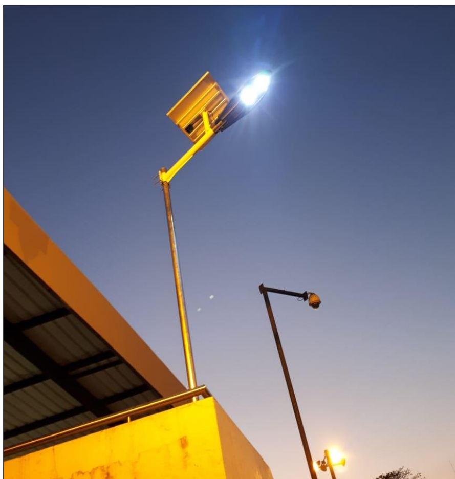
Figura 8. 6 Luminaria 2 instalada en los exteriores de FETD Elaborado por: El autor.
