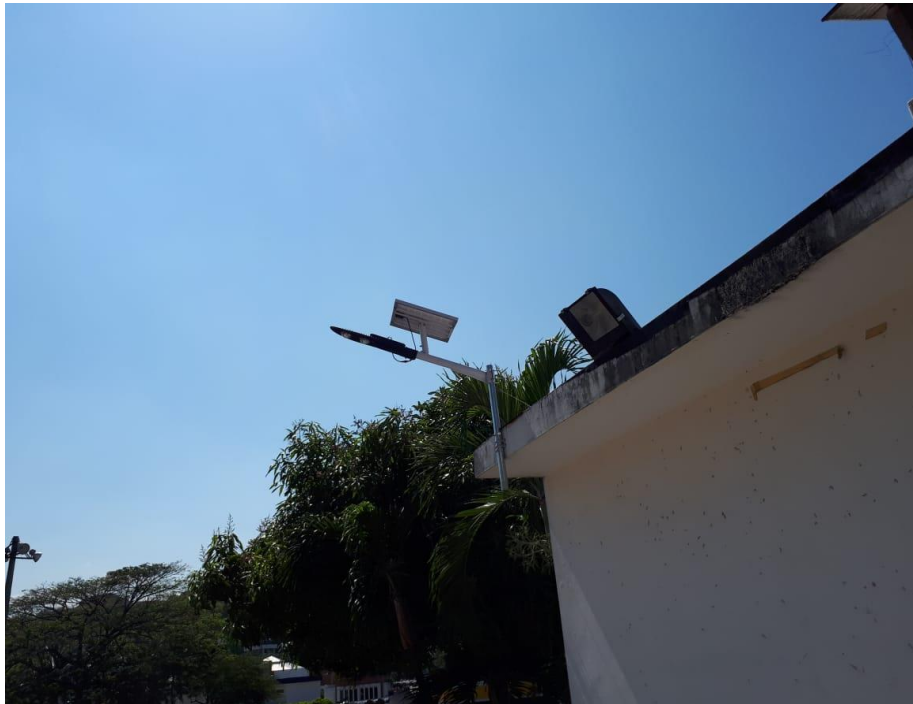
Figura 8. 7 Vista lateral de la luminaria 1 Elaborado por: El autor.
