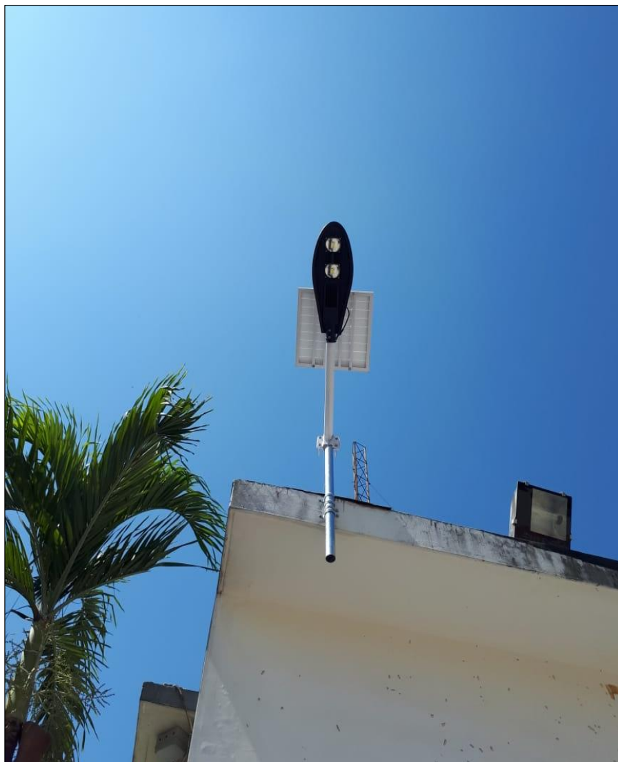
Figura 8. 3 Luminaria 1 instalada en los exteriores de la FETD Elaborado por: El autor.
