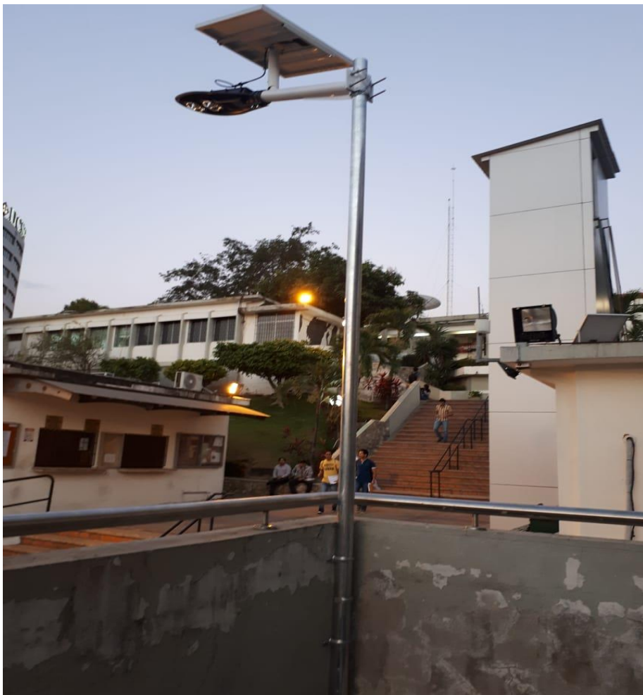
Figura 8. 8 Vista lateral de la luminaria 2 Elaborado por: El autor.
