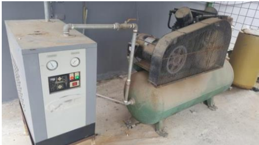
Figura 42. Compresor y secador instalado en la planta doña juanita
