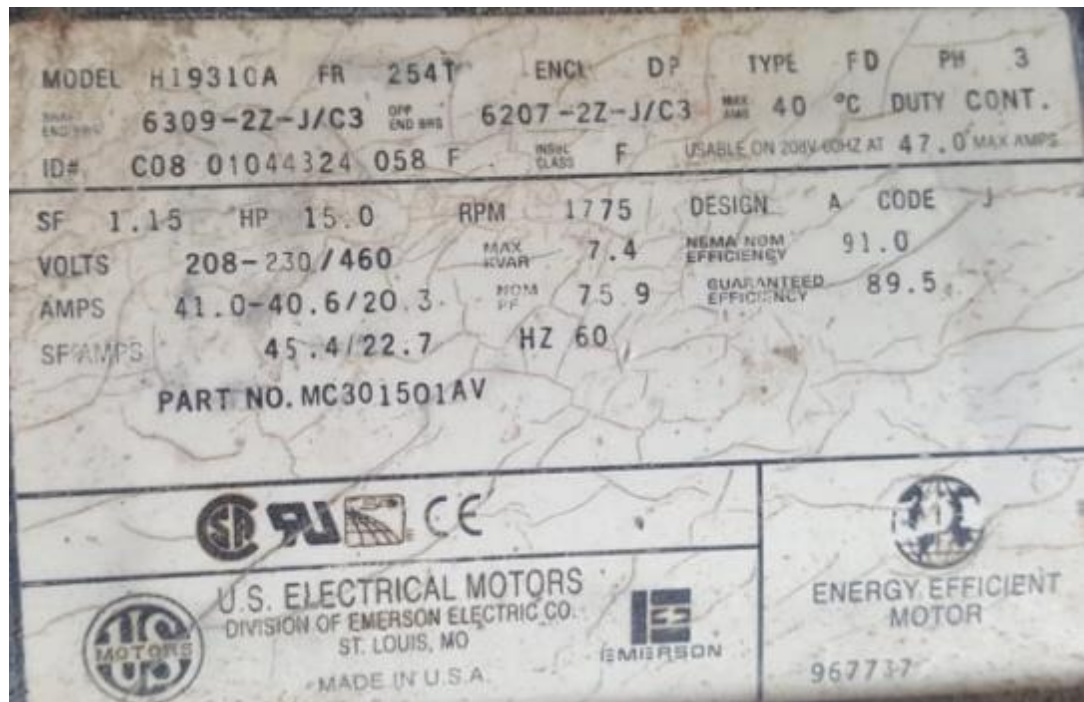
Figura 40. Placa característica del motor del compresor Fuente: Investigación de campo, 2019
