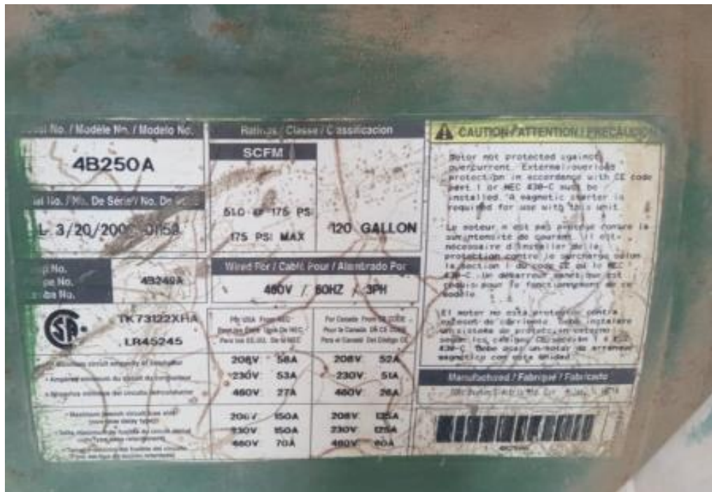
Figura 41. Placa del tanque de depósito del compresor
