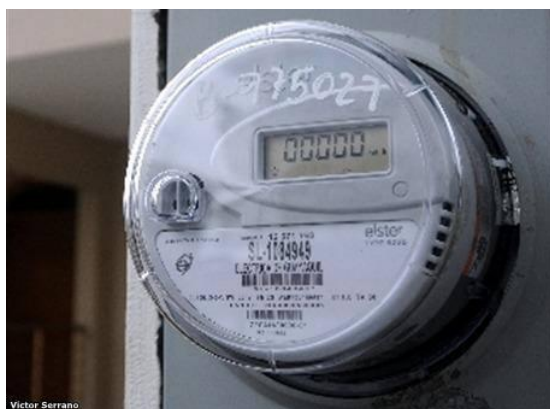
Figura 3 Medidor de energía eléctrica residencial
