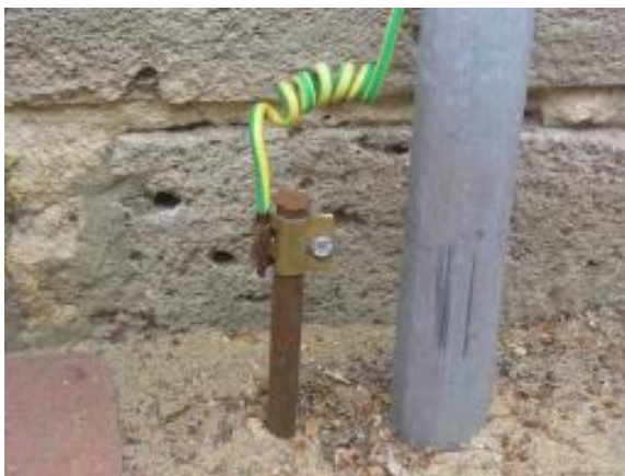
Figura 5 Toma de tierra
