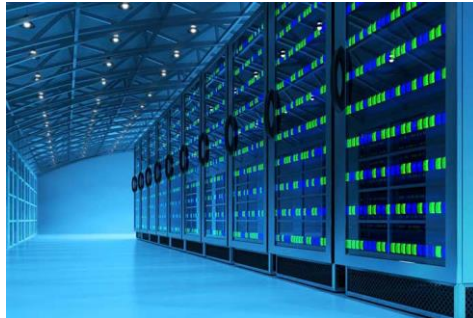
Figura 8. Centro de datos. Recuperado de: https://grupocartronic.com/soluciones-infraestructura-datacenter
