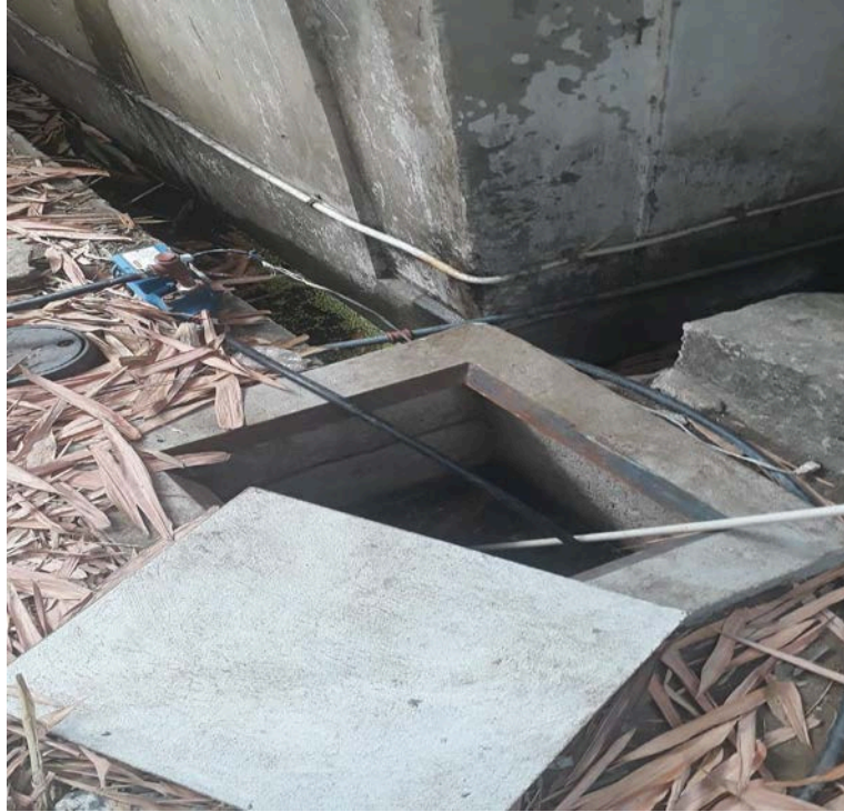
Ilustración 12 Caja de revisión de aguas residuales
