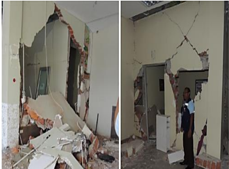
Ilustración 23. Fisuras y colapso de paredes en Aeropuerto Eloy Alfaro. Fuente: GEER-ATC. Earthquake Reconnaissance, 2016.
