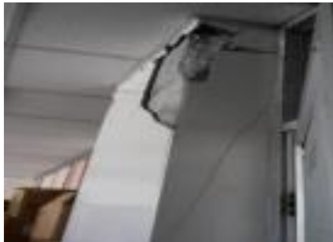
Ilustración 31. Desprendimiento de enlucido de la columna. Fuente: Ing. Roberto Aguiar, 2016.
