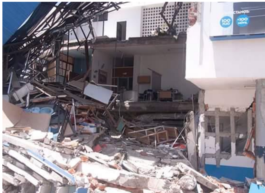
Ilustración 28. Edificio CNT Portoviejo después del sismo. Fuente: Ing. Alex Villacrés, 2016.
