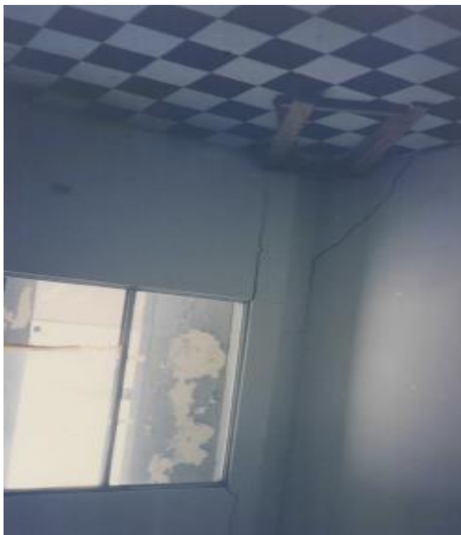
Ilustración 12. Fisuras en pared y esquina de ventanas. Fuente: Ing. Alex Villacrés, 1998.
