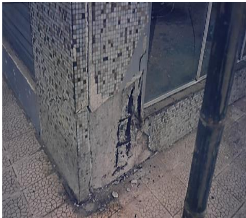
Ilustración 8. Desprendimiento de enlucido. Fuente: Ing. Alex Villacrés, 1998.
