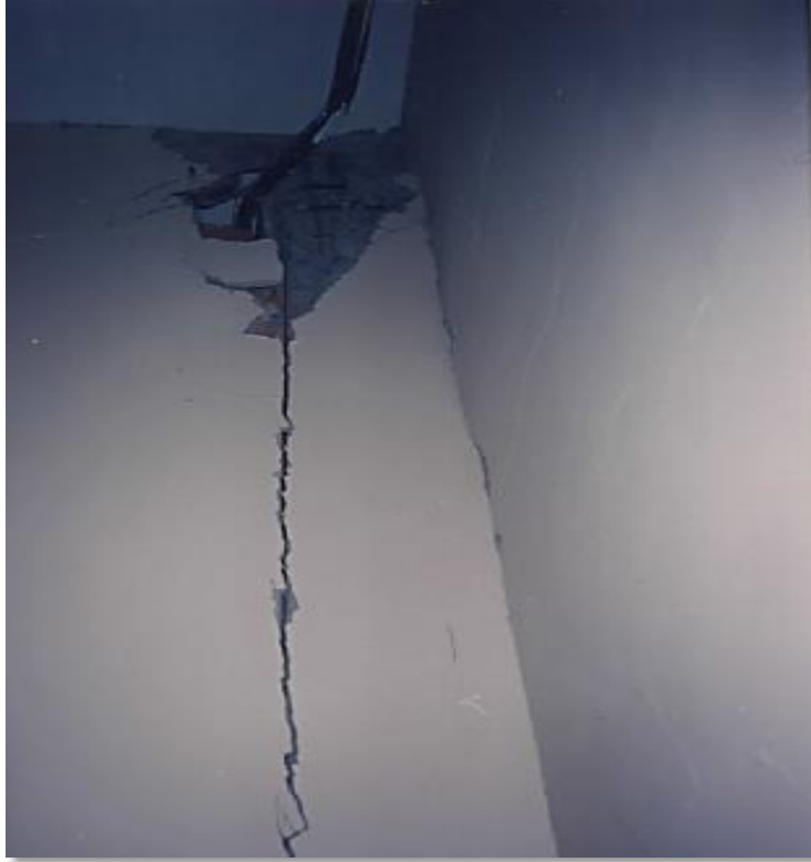
Ilustración 9. Fisura longitudinal en paredes. Fuente: Ing. Alex Villacrés, 1998.
