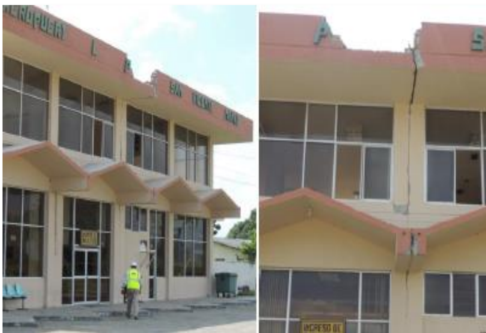
Ilustración 37. Golpeteo y colapso de techo en aeropuerto Los Perales San Vicente. Fuente: GEER-ATC Earthquake Reconnaissance, 2016.
