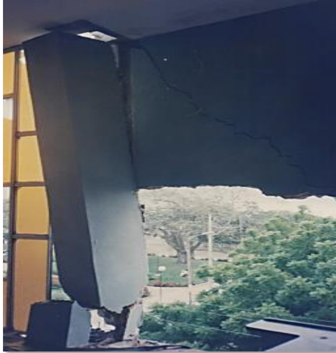
Ilustración 13. Falla por cortante en columna. Fuente: Ing. Alex Villacrés, 1998.
