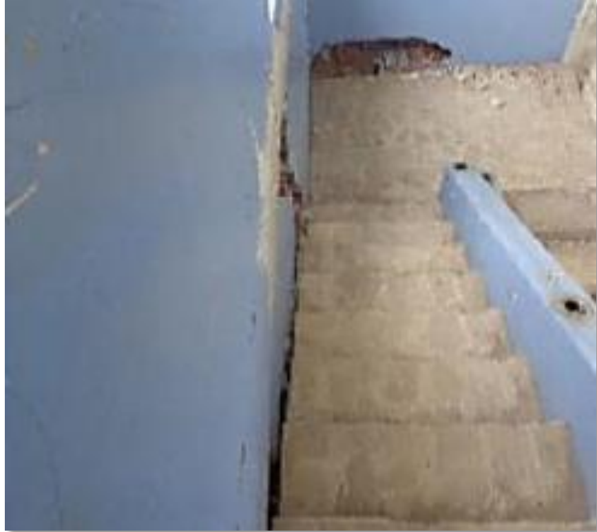
Ilustración 32. Separación de la escalera después del sismo del edificio CNEL Manta. Fuente: Ing. Roberto Aguiar, 2016.
