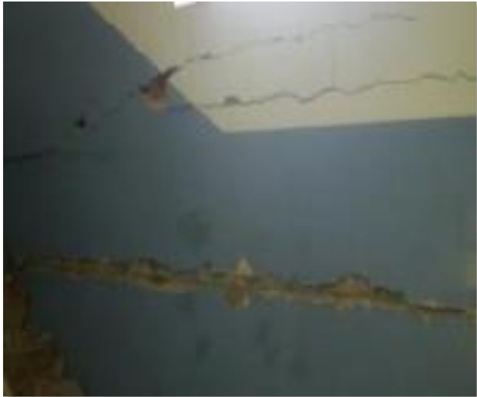
Ilustración 34. Grietas en mampostería después del sismo del edificio CNEL Manta. Fuente: Ing. Roberto Aguiar, 2016.
