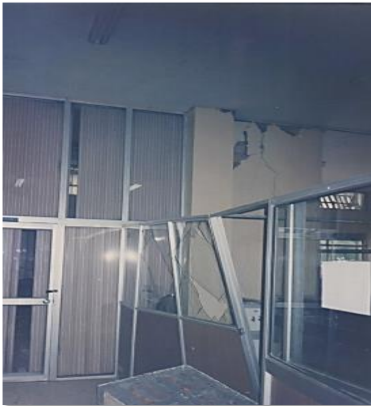
Ilustración 10. Daños en puertas y desprendimiento de enlucido. Fuente: Ing. Alex Villacrés, 1998.
