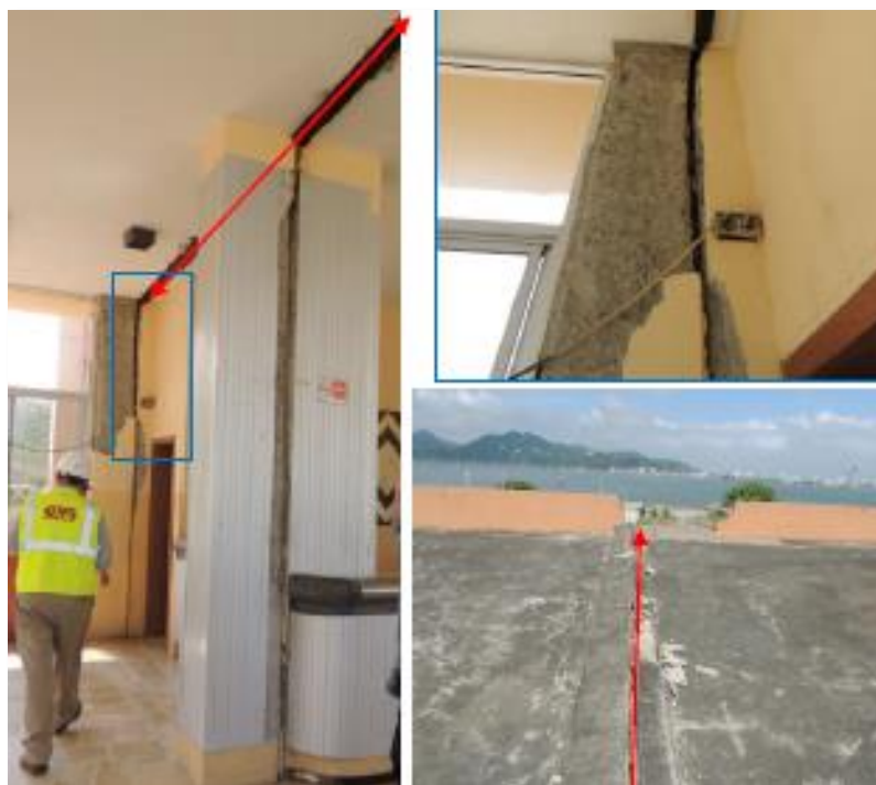
Ilustración 38. Golpeteo de columna aeropuerto Los Perales San Vicente. Fuente: GEER-ATC Earthquake Reconnaissance, 2016.
