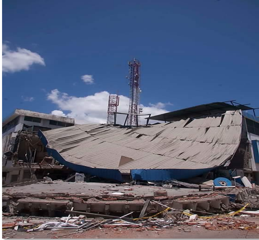
Ilustración 27. Edificio CNT Portoviejo después del sismo. Fuente: Ing. Alex Villacrés, 2016.
