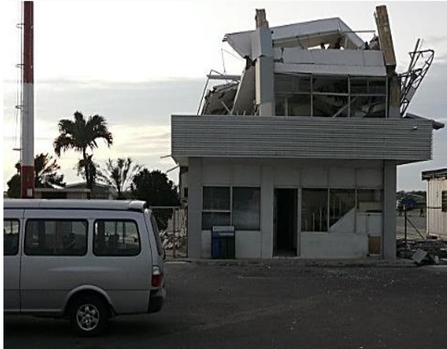
Ilustración 21. Torre de control aérea Manta después del sismo 2016. Fuente: Ecuavisa, 2016.
