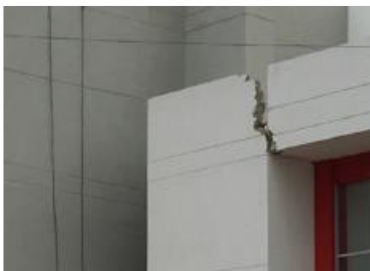
Ilustración 18. Fisura en fachada del edificio ECU-911 Portoviejo. Tomado de: GEER-ATC. Earthquake Reconnaissance, 2016.
