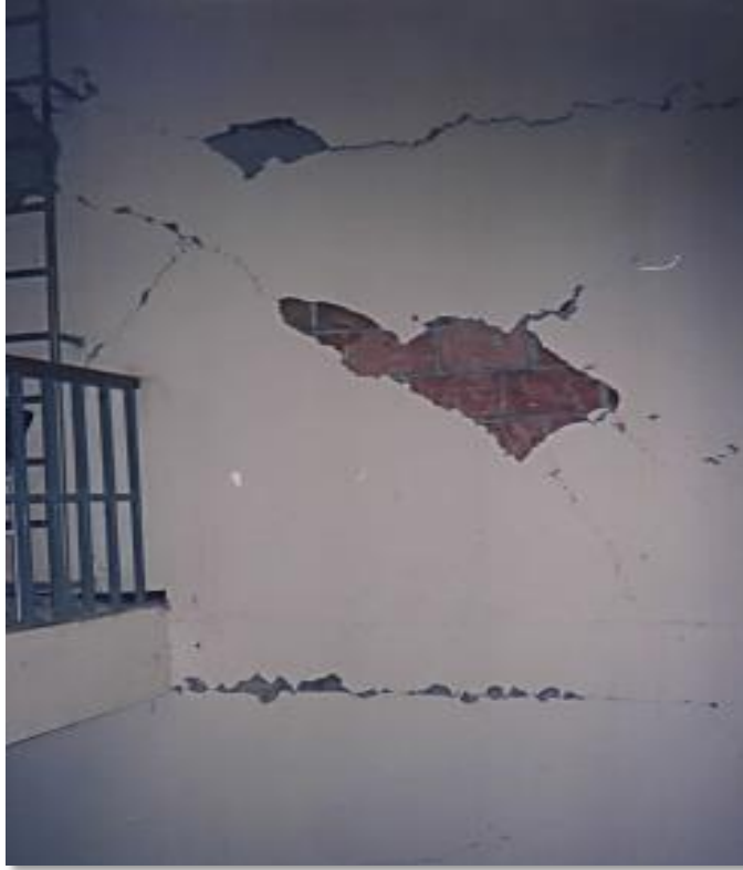
Ilustración 11. Fisura en paredes y desprendimiento de enlucido. Fuente: Ing. Alex Villacrés, 1998.
