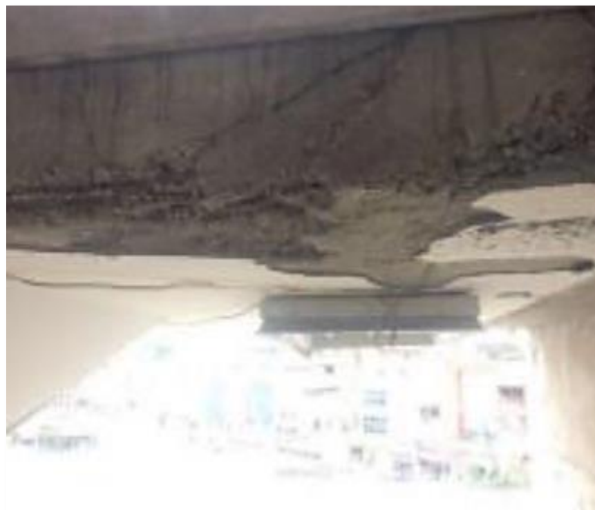
Ilustración 33. Desprendimiento de recubrimiento en viga después del sismo del edificio CNEL Manta. Fuente: Ing. Roberto Aguiar, 2016.
