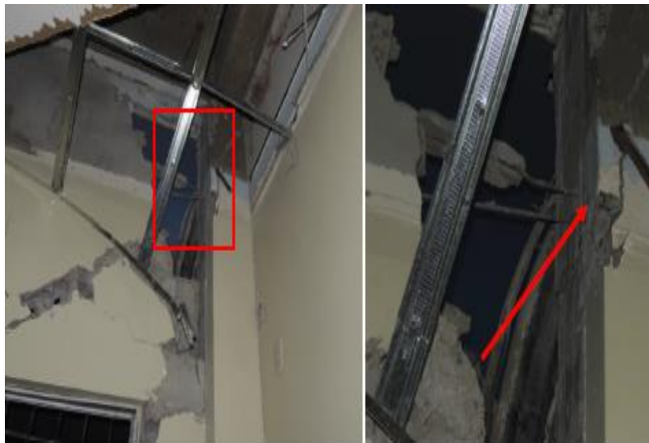
Ilustración 24. Colapso parcial de pared donde hubo clavijas de las columnas incrustadas en la pared. Fuente: GEER-ATC Earthquake Reconnaissance.2016.
