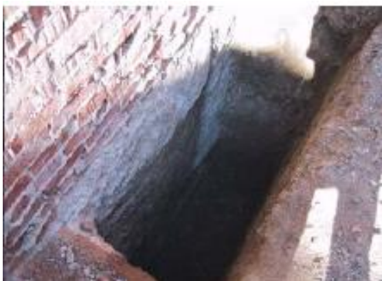
Figura 18. Excavación en pozo para cimentación. Recuperado de “Las actuaciones en el terreno y la cimentación”, de Amo, P.M.P.D. (2015), p. 56, Madrid.
