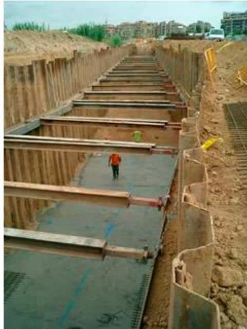
Figura 34. Pantallas de tablestacas arriostradas con perfilera metálica. Recuperado de “Procedimientos de construcción de cimentaciones y estructuras de contención”, de Yepes, V.P., p. 151, España.
