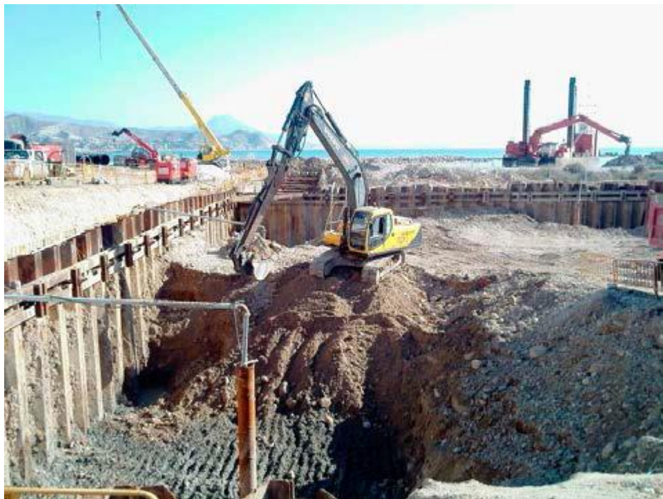
Figura 33. Pantalla arriostrada al terreno. Recuperado de “Procedimientos de construcción de cimentaciones y estructuras de contención”, de Yepes, V.P., p. 149, España.
