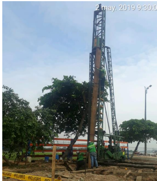
Figura 43. Posicionamiento de la Tablestaca en el sitio de la hinca. Por C. Fajardo. (Durán, 2019).
