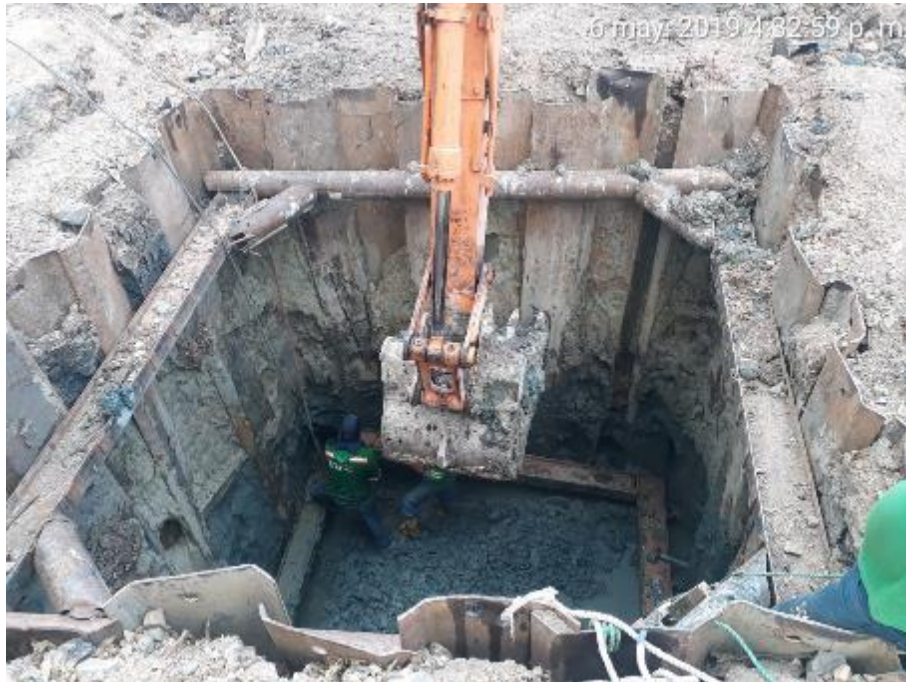
Figura 45. Anillos colocados en el tablestacado para dar mayor seguridad para el empuje lateral de la tierra. Por C. Fajardo. (Durán, 2019).
