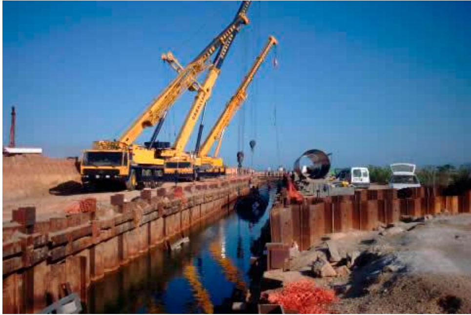
Figura 35. Tablestaca arriostrada. Recuperado de “Procedimientos de construcción de cimentaciones y estructuras de contención”, de Yepes, V.P., p. 152, España.
