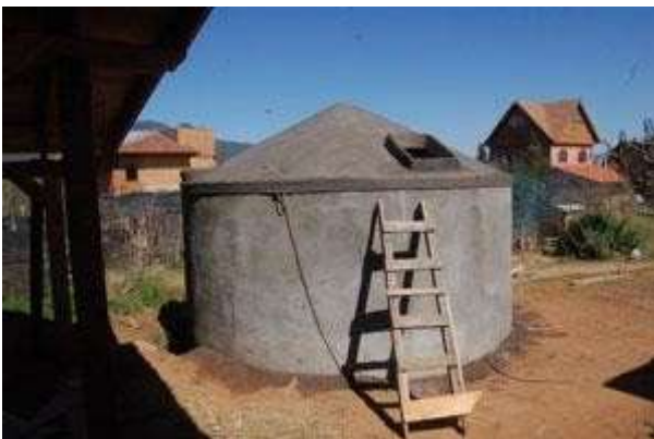
Una vez que se quite la cimbra del techo, nos toca el trabajo más duro de la construcción de la cisterna: poner la primera mano al techo desde el interior....
