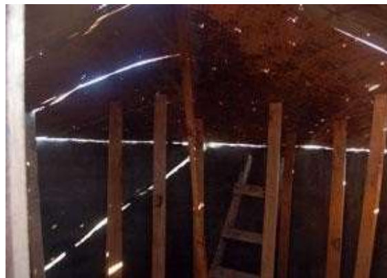
la cimbra se sostiene con amarres hacia la estructura, y algunas fajillas para soportar el peso inicial de la mezcla húmeda
