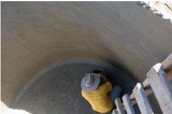
Por último, después de dos capas de mezcla (el "aplanado" y el "fino") se pinta el interior de la cisterna con una "lechada" de cemento
