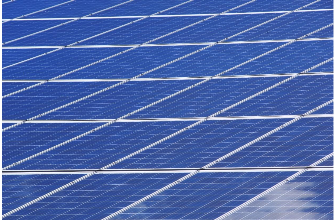
Figura 4 Arreglo de paneles solares fotovoltaicos. GettyImages
