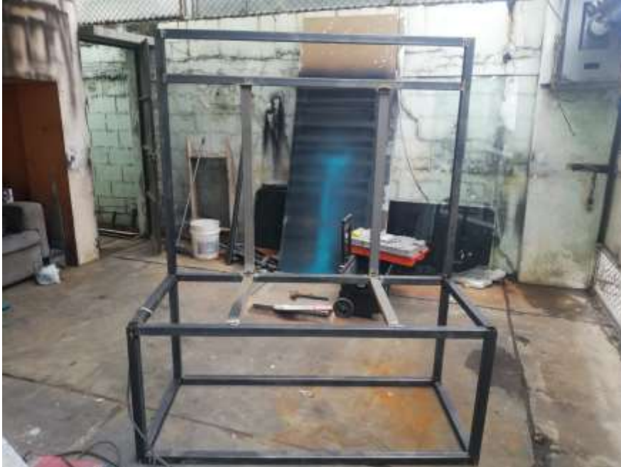
Figura 89 Refuerza de la estructura Fuente: Harold Gherardy
