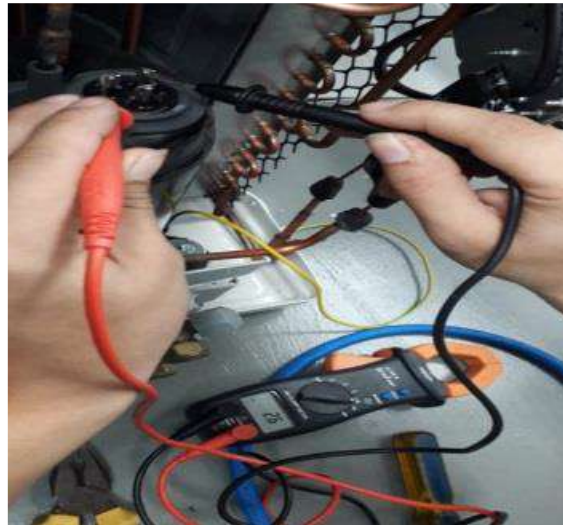
Figura 30 Medición de las bobinas del compresor
