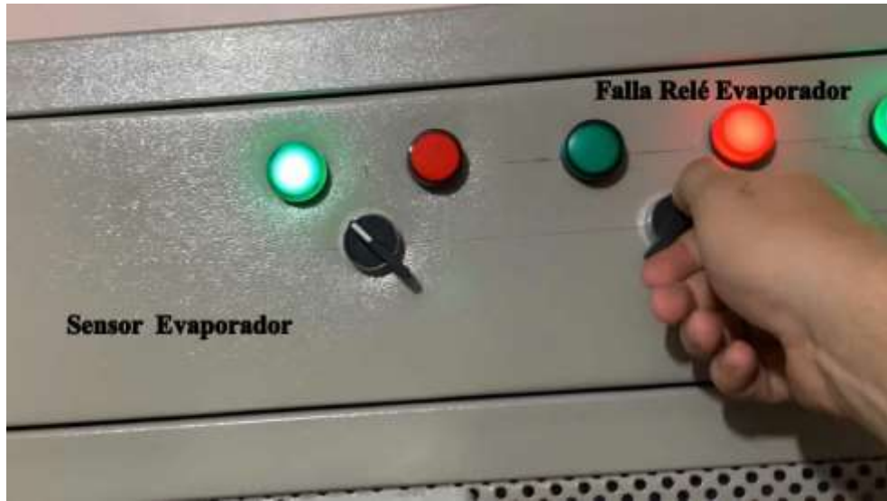
Figura 44 Falla del Relé del Evaporador
