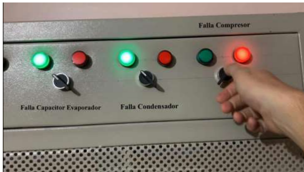
Figura 45 Activación de falla del Condensador
