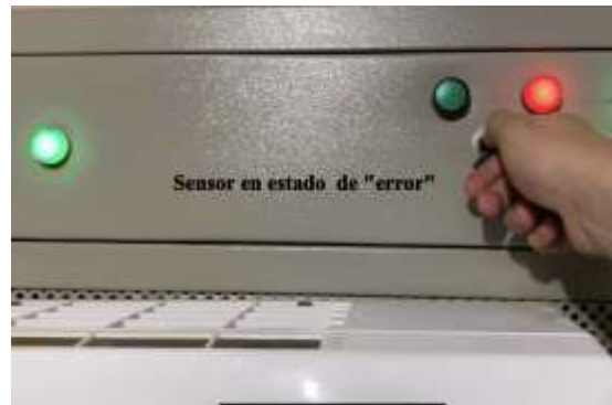
Figura 41 Sensor del evaporador en estado error
