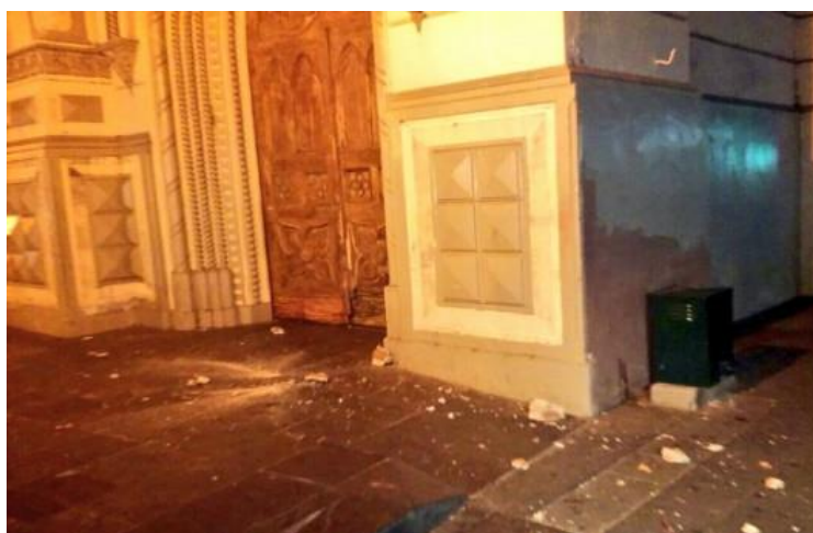
Ilustración 14 Caída de fragmentos de mampostería de la torre Este durante el sismo del 27 de noviembre de 2017. Obtenida de Alex Villacrés.
