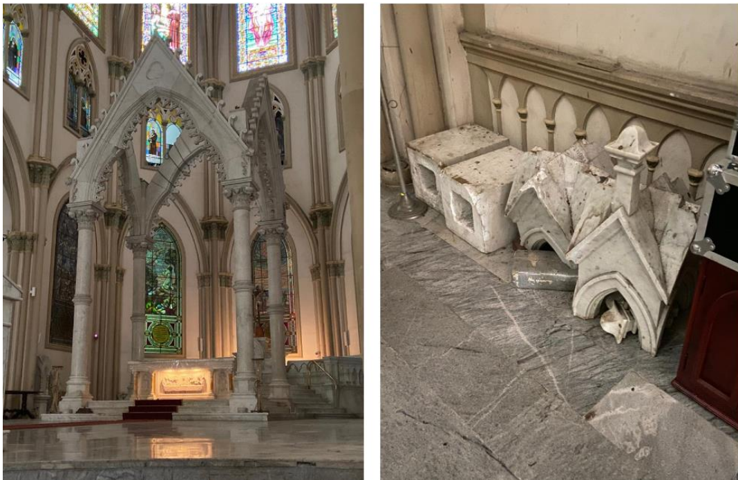
Ilustración 10 Daños presentados en el baldaquino como grietas y pérdida de elementos, a la derecha se puede observar las piezas recuperadas. Fuente Andrei Moreno 15/10/2019
