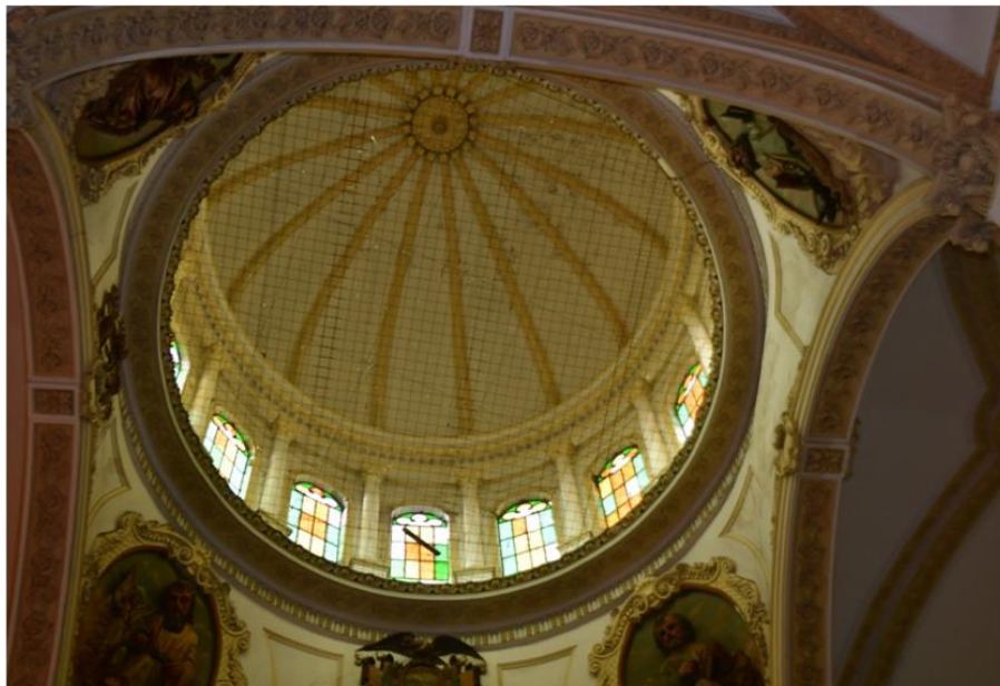
Ilustración 12 Daños en iglesia de La Victoria en Guayaquil, resquebrajamiento de las cúpulas. Extraída de diario El Universo, 01 de mayo del 2019.
