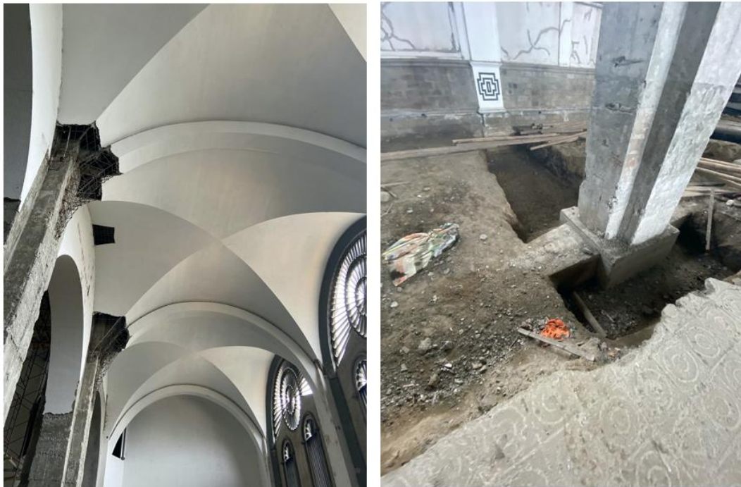
Ilustración 22 Fallas estructurales en tumbado y piso
