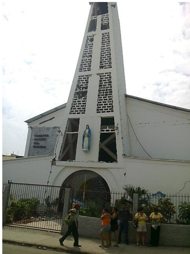
Ilustración 26 Iglesia Nuestra Señora del Rosario después del sismo del 16 de abril del 2016 con múltiples fallas, parroquia Tarqui-Manta.
