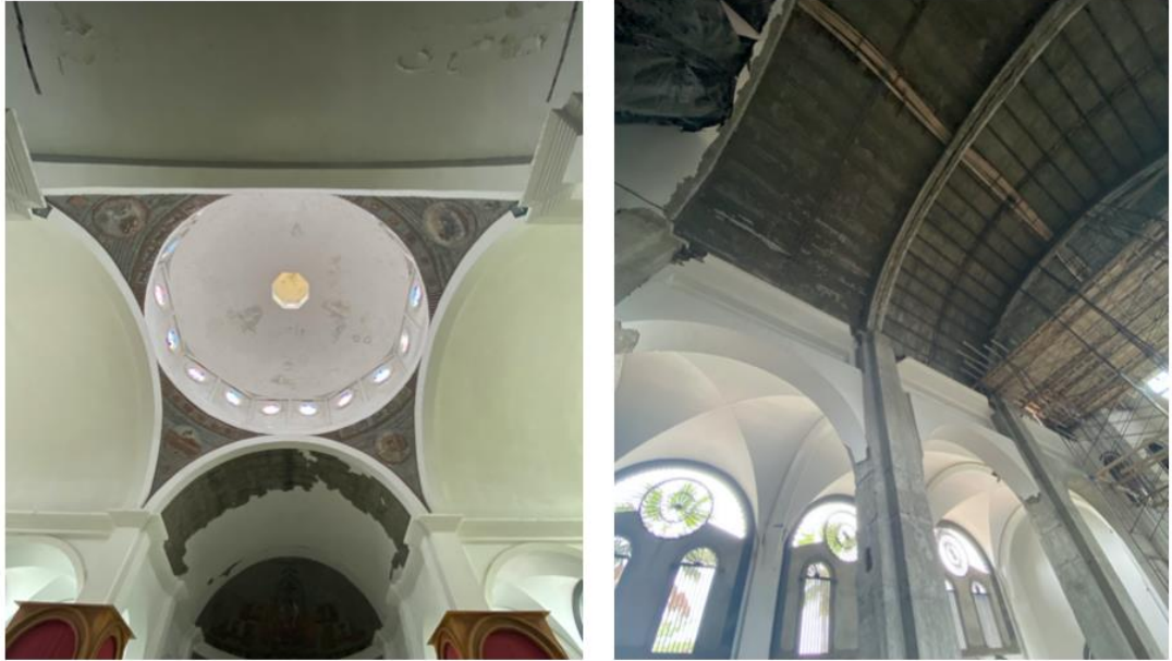
Ilustración 23 Caída del recubrimiento del tumbado en las naves.
