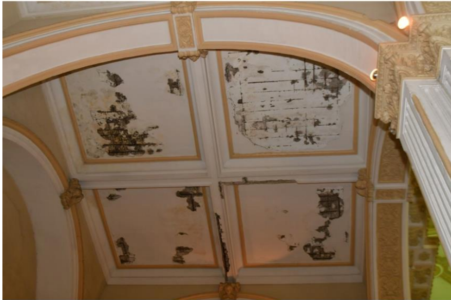
Ilustración 1 Daños en iglesia de La Victoria en Guayaquil alarman a fieles por los daños persistentes desde el sismo del 2016, extraída de diario El Universo, 01 de mayo del 2019.
