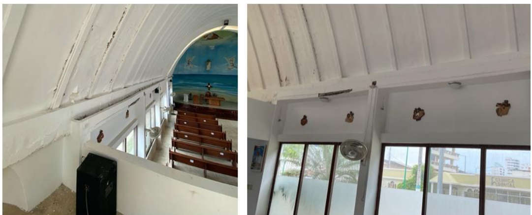
Ilustración 33 Fisuras provocadas por el poco mantenimiento recibido, Bahía de Caráquez.
