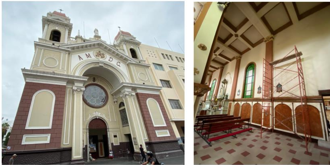
Ilustración 17 Iglesia San José con daños leves como fisuras en el empastado de paredes interiores y agrietamiento en tumbado.
