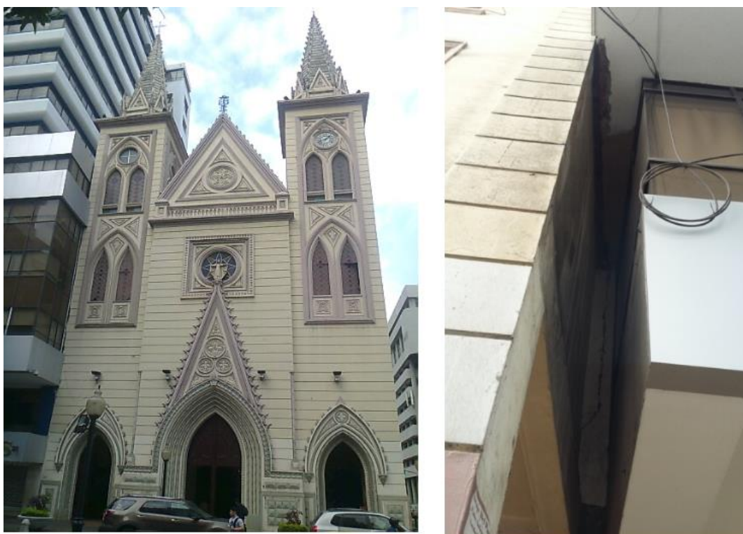
Ilustración 13 Daños en la fachada del Templo de La Merced por adosamiento y colisión con el edificio de la Fiscalía del Guayas (ex – Banco Continental) durante movimientos sísmicos. Obtenido de Andrei Moreno.
