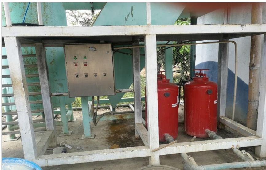
Ilustración 34.- Vista frontal del sistema de tratamiento para potabilización del agua.
