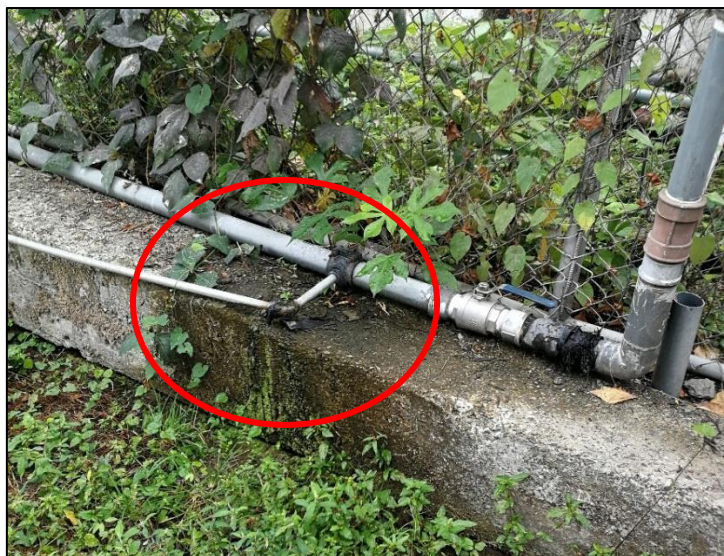
Ilustración 59.- Fuga de agua en la planta de tratamiento de Piñal de Arriba.
