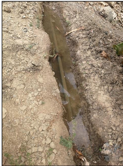
Ilustración 58.- Rotura de tubería de la red secundaria del recinto Piñal de Arriba.
