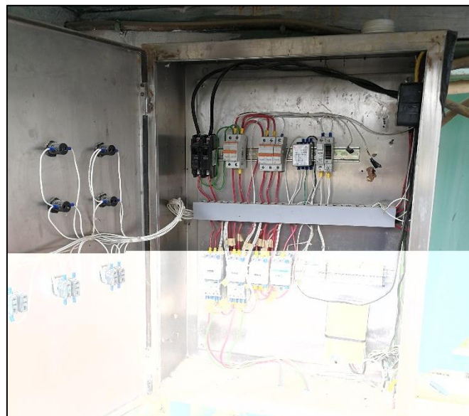
Ilustración 56.- Conjunto de breques del sistema eléctrico de la planta potabilizadora.
