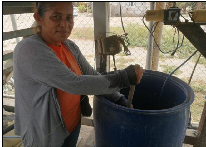
Ilustración 39.- Mezcla manual del sulfato de aluminio en tanque de PVC común.
