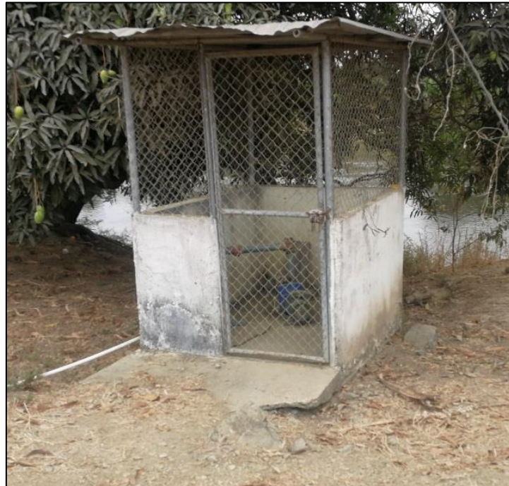
Ilustración 29.- Primera estación de bombeo. Función: Captar y enviar el agua del río Daule hacia la planta de potabilización.
