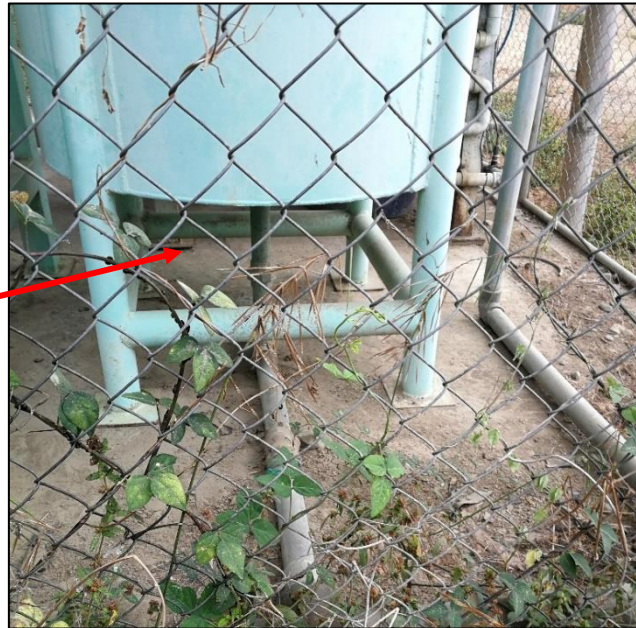
Ilustración 37.- Tubería para eliminar sedimentos que están reposando al fondo del reservorio.
