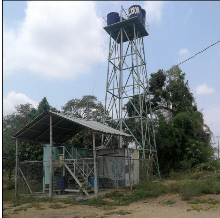
Ilustración 25.- Vista General del sistema de potabilización del recinto Piñal de Arriba.
