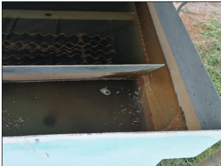
Ilustración 44.- Traslado del agua a través de canales extremos que presenta el tanque sedimentador.
