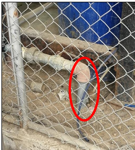
Ilustración 32.- Tubería de conducción.
