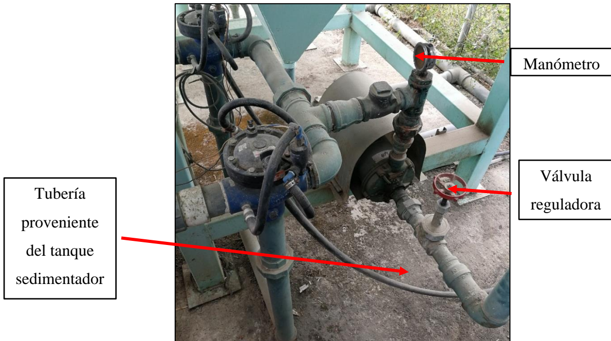
Ilustración 45.- Bomba centrífuga# 3 del sistema de potabilización de agua, con presencia de válvula y manómetro.
