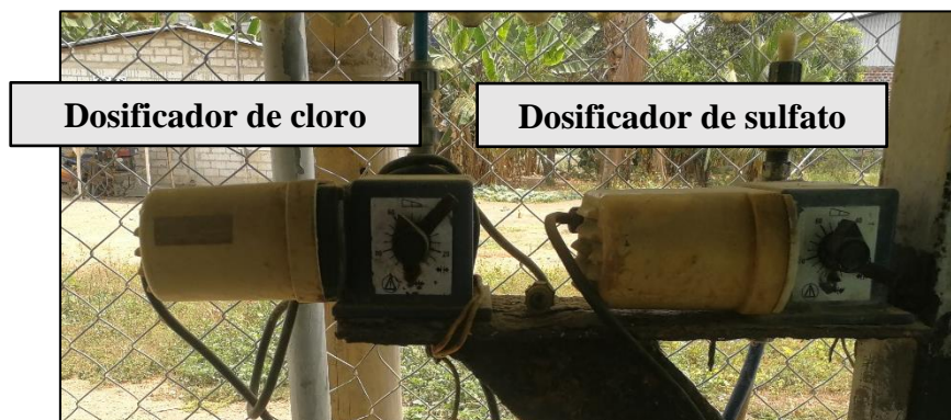
Ilustración 38.- Reguladores de dosificación para el sulfato de aluminio y el cloro.
