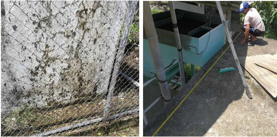
Ilustración 50.- Medición y vista exterior del primer reservorio de almacenamiento bajo.
