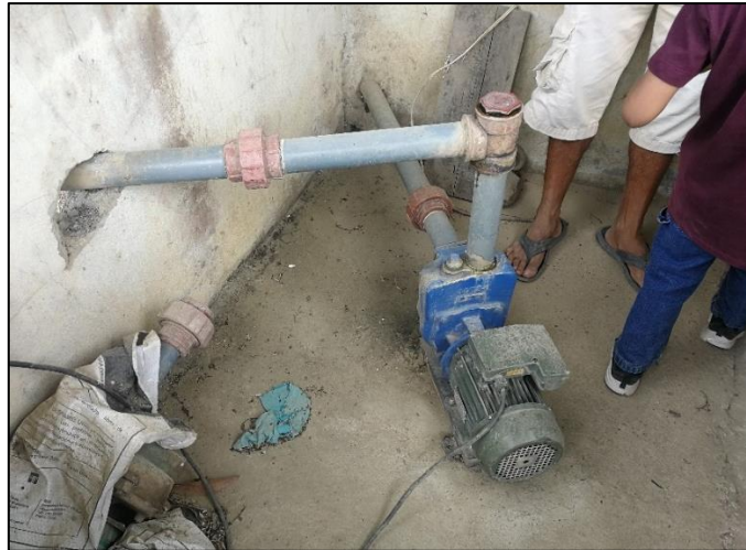
Ilustración 31.- Bomba# 1 de la primera estación de bombeo marca SAER.
