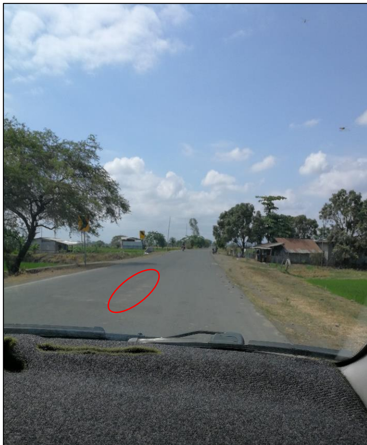
Ilustración 23.- Infraestructura vial Magro - Piñal de Arriba. Daño: Abultamientos y hundimientos.
