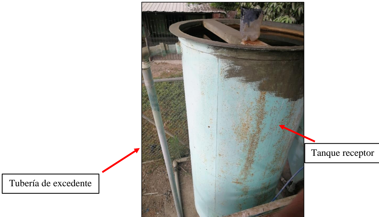
Ilustración 35.- Tanque receptor del agua proveniente de la línea de conducción.
