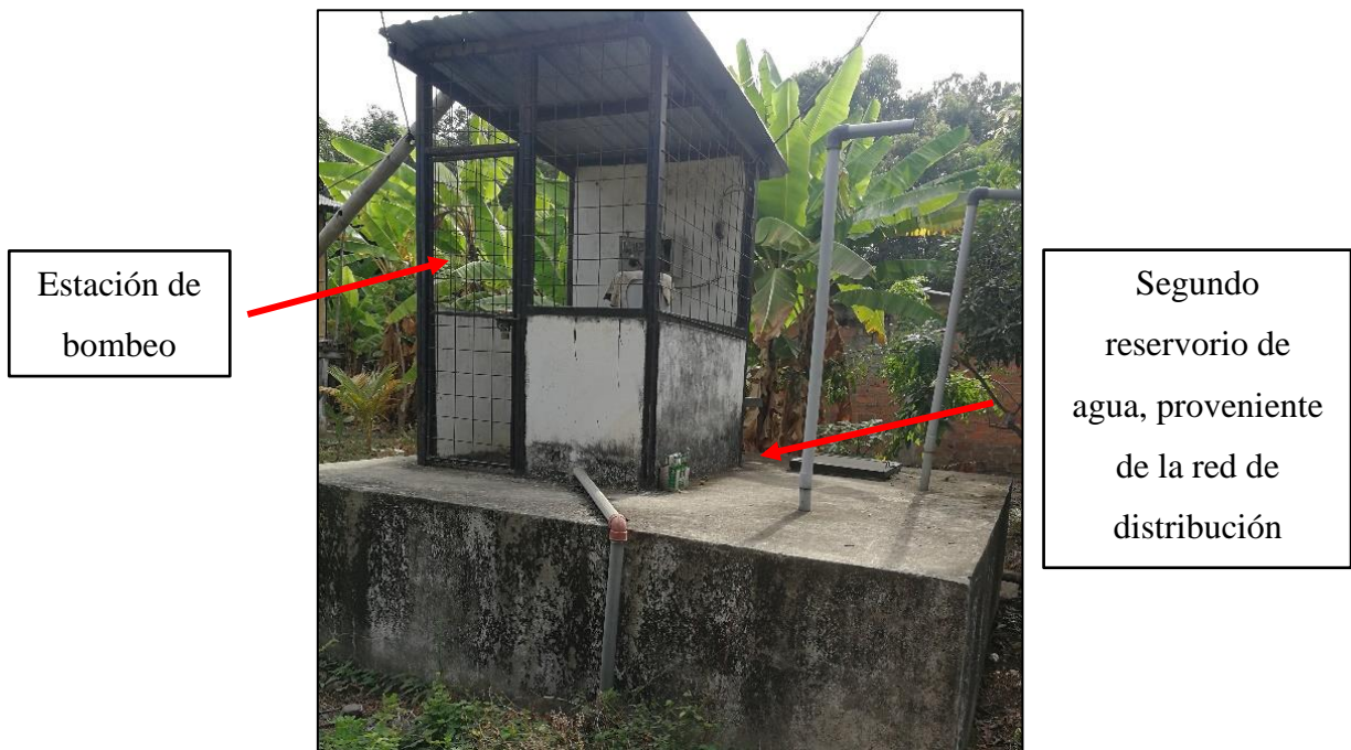
Ilustración 30.- Segunda estación de bombeo. Función: Captar y enviar agua del reservorio hacia el sector faltante de Piñal de Arriba.
