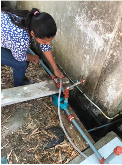
Fotografía 11: Sistema de Bombeo hacia el tanque homogeneizador.
