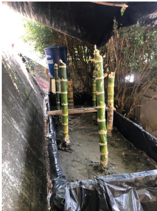
Fotografía 10: Planta Piloto con Tanque homogeneizador.
