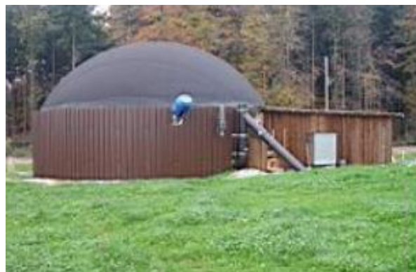
Figura 2. 15 Biodigestor con Tanque de Almacenamiento Tradicional
