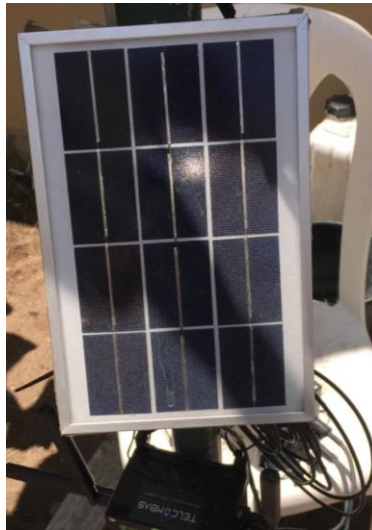
Figura 3.28: Panel solar, fuente de alimentación del Gateway .
