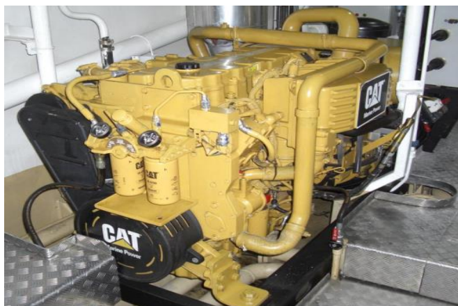
Figura 2. 13 Motor y generador Caterpillar modelo C4.4 DITA de un remolcador marítimo
