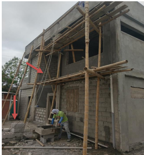
Ilustración 35: Falta de Seguridad en izajes de bloques y objetos.
