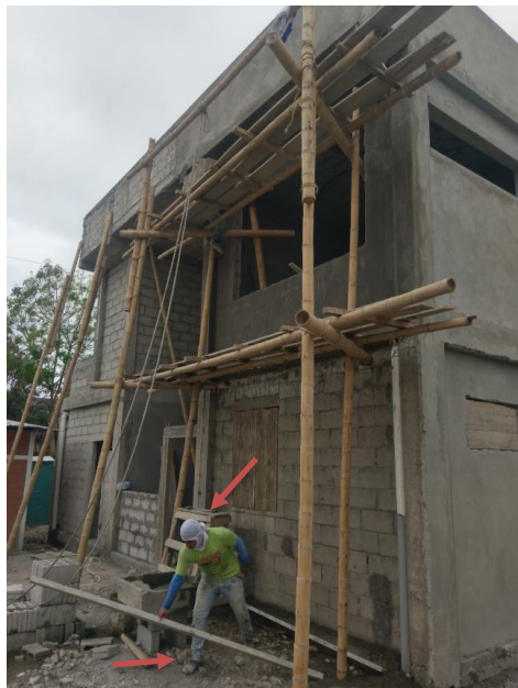
Ilustración 32: Ausencia de EPP por parte de personal obrero.
