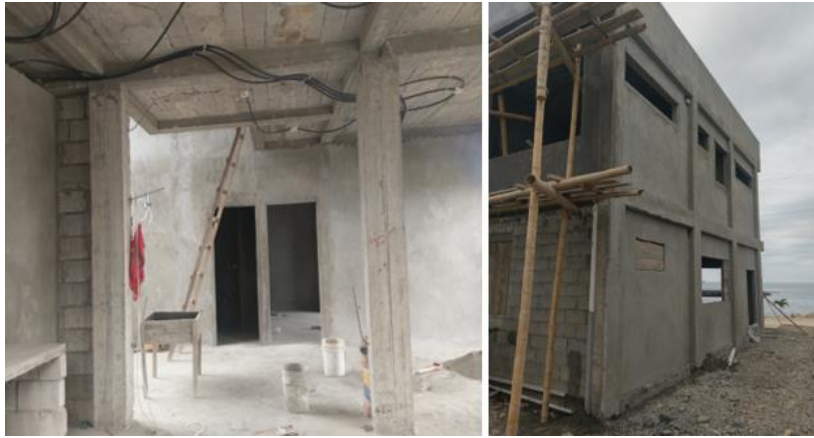
Ilustración 34: Ausencia de señalética preventiva.
