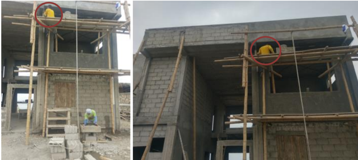
Ilustración 33: Ausencia de protección para trabajos en altura y líneas de vida.
