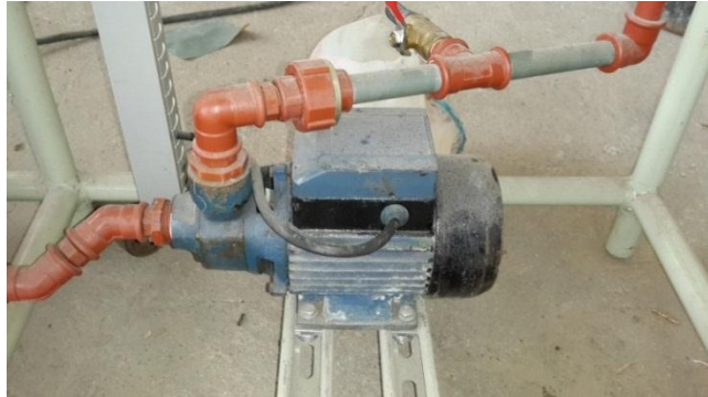
Figura 4.6 Selección Equipos Bomba de agua
