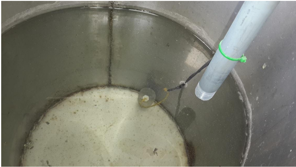
Figura 4.16 Selección Equipos Sensor digital de nivel 2
