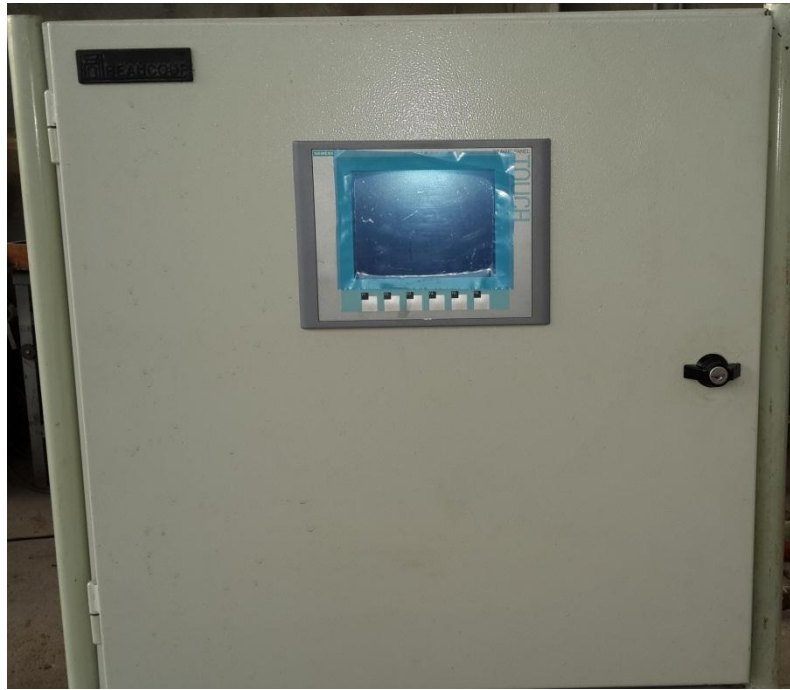
Figura 4.21 Selección Equipos Tablero Metálico
