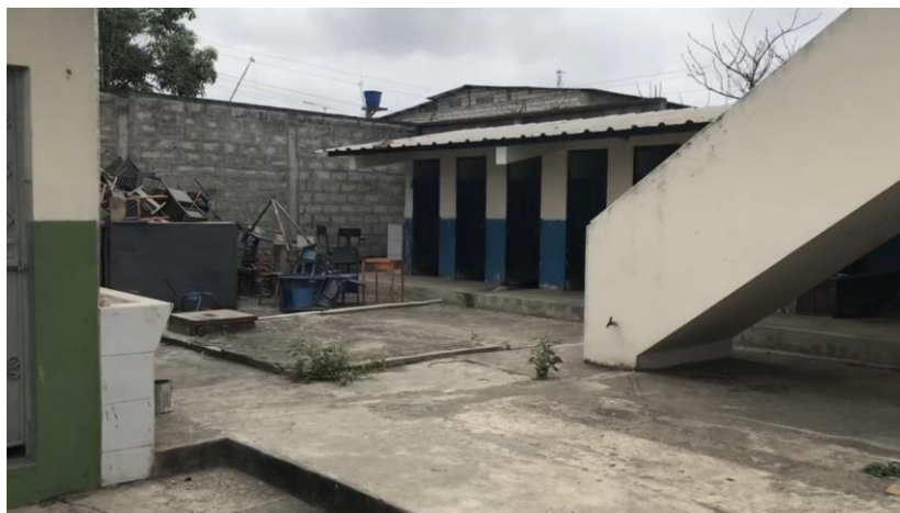
Los baños de la institución se mantienen sin uso y la zona se utiliza para colocar pupitres dañados | Foto: Melina León
