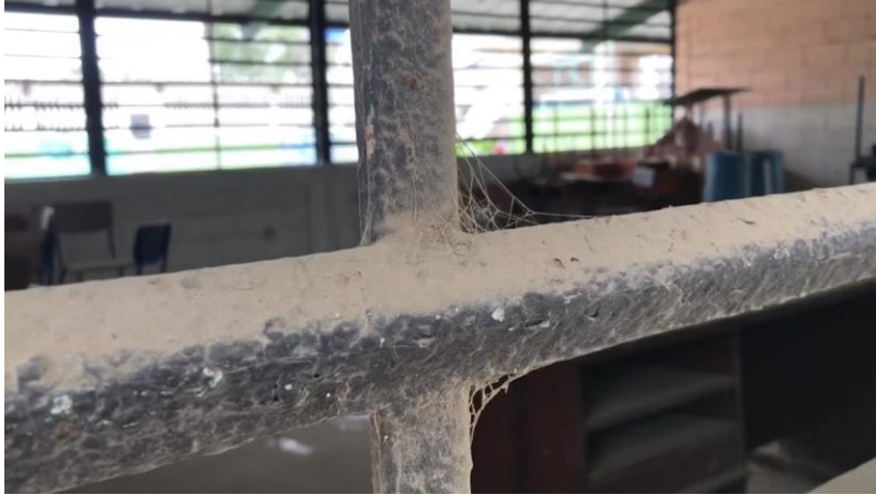
Las aulas están llenas de telarañas y polvo debido al poco mantenimiento.
