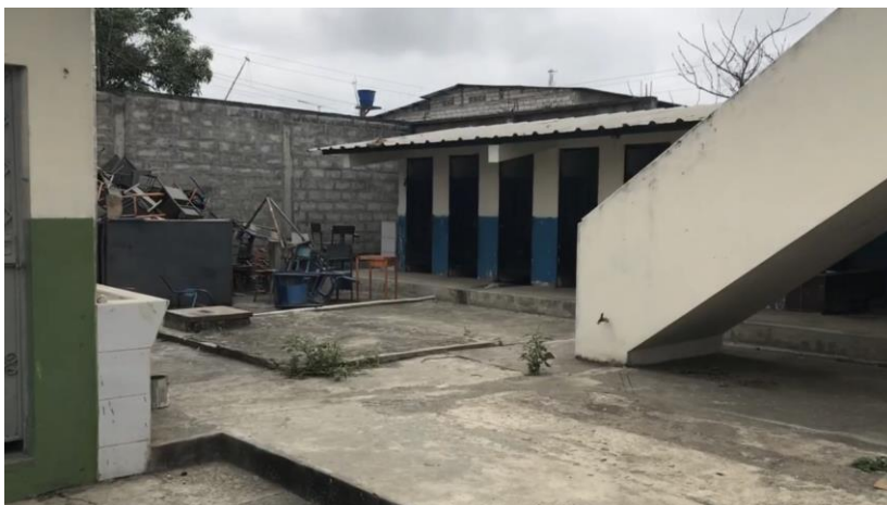
Los baños de la institución se mantienen sin uso y la zona se utiliza para colocar pupitres dañados.
