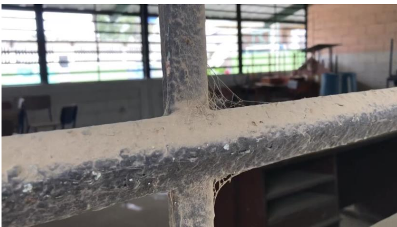
Las aulas están llenas de telarañas y polvo debido al poco mantenimiento | Foto: Melina León
