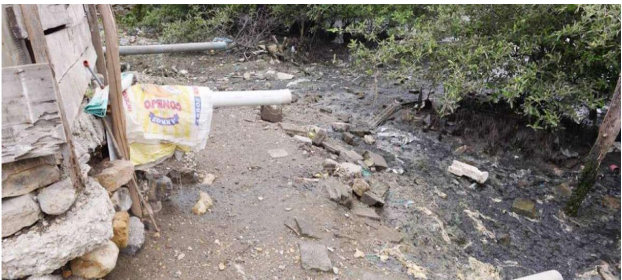
Ilustración 6. Tubería de descargas de aguas residuales domésticas en el año 2015.
