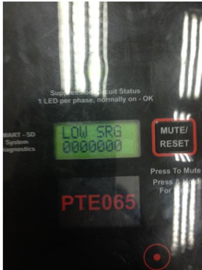
Figura 4.4 Inicio de contador de eventos EATON
