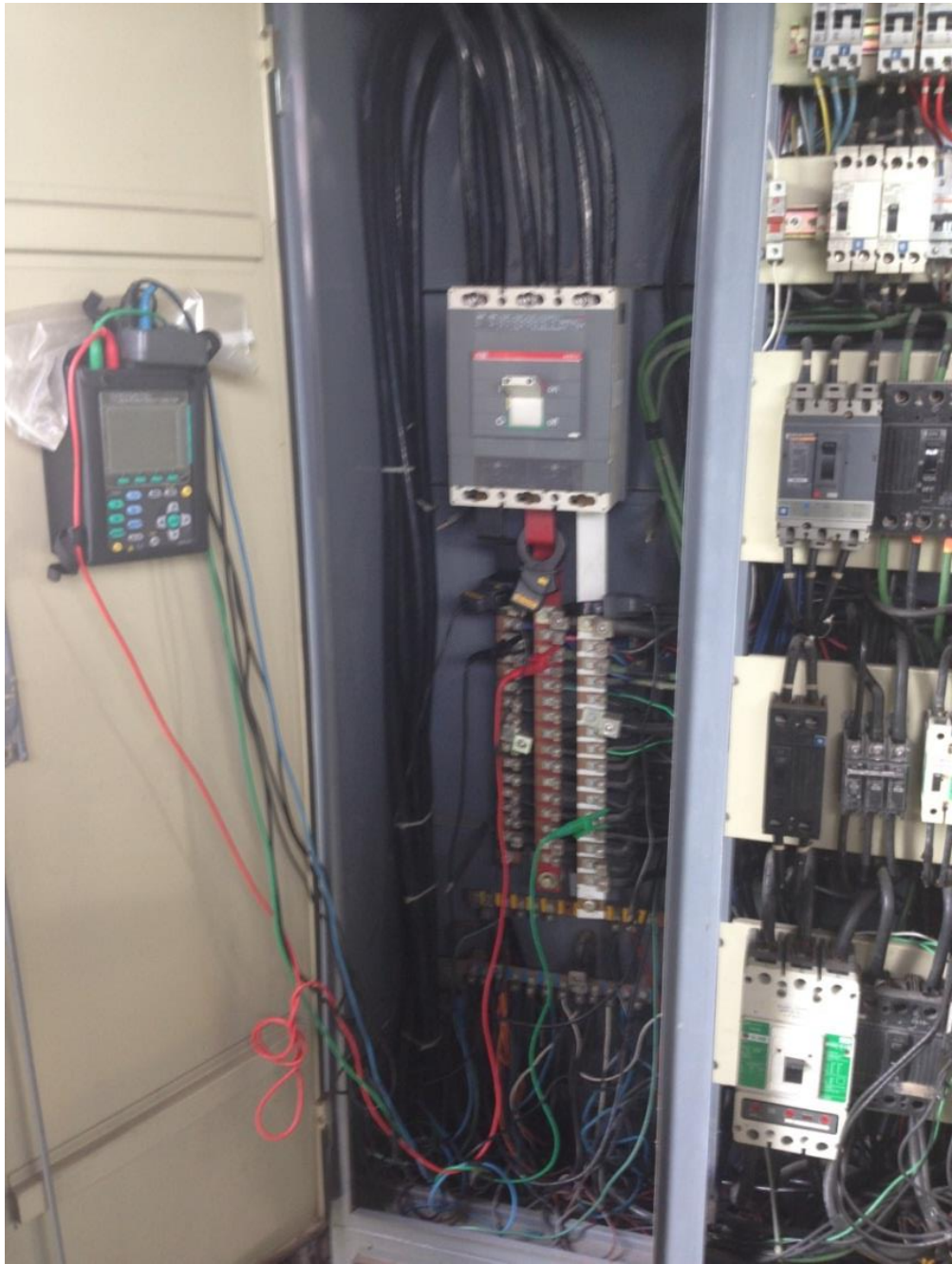
Figura 3.3 Vista completa de la instalación
