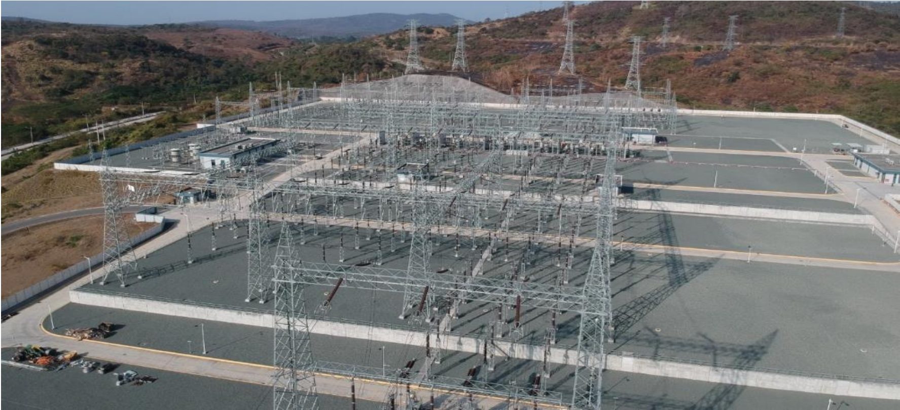
Figura 20 Subestación Chorrillos 500kV
