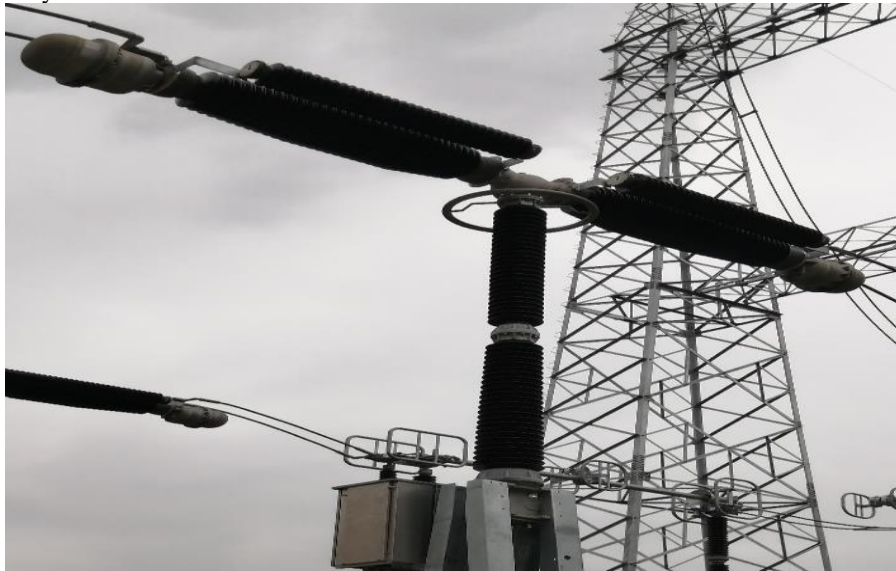
Figura 1 Disyuntor de 500 kV
