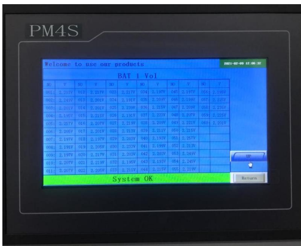
Figura 26 PLC del banco de baterías
