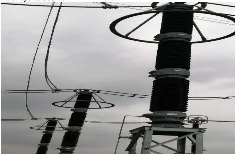
Figura 8 Pararrayo de 500 kV
