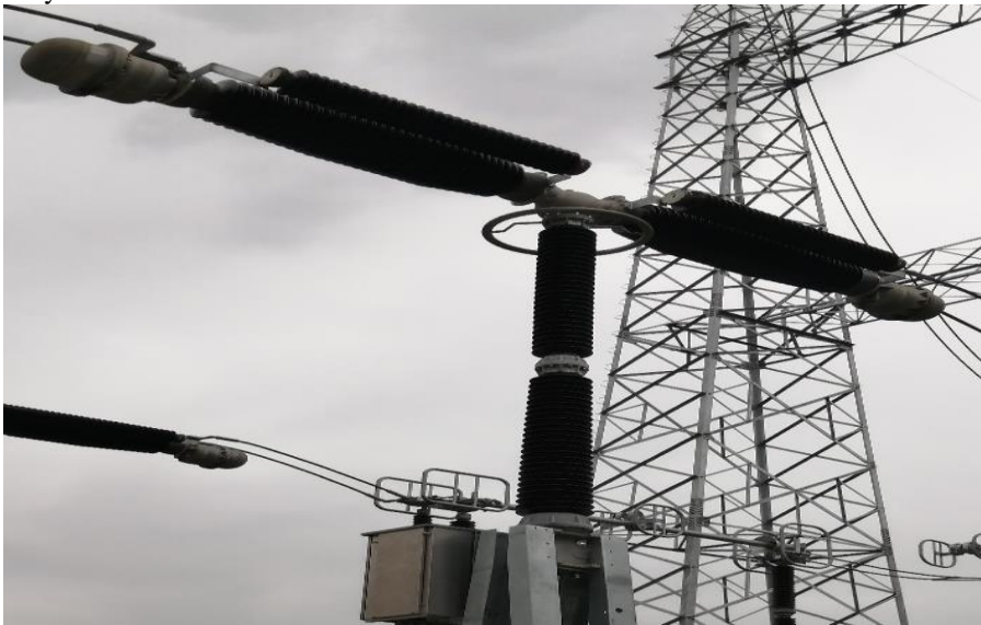
Figura 33 Disyuntor de 500 kV
