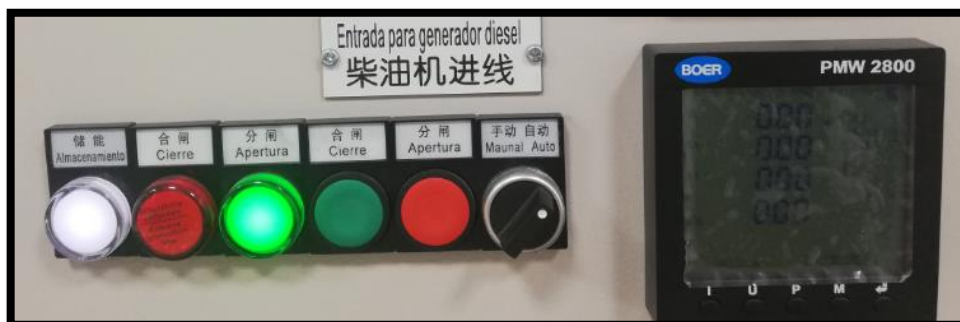
Figura 41 Indicadores de estados de interruptores de 0.48kV
