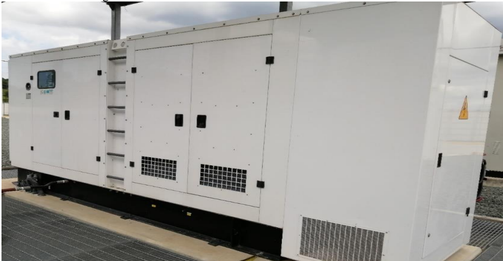
Figura 9 Generador de emergencia 0.48 kV
