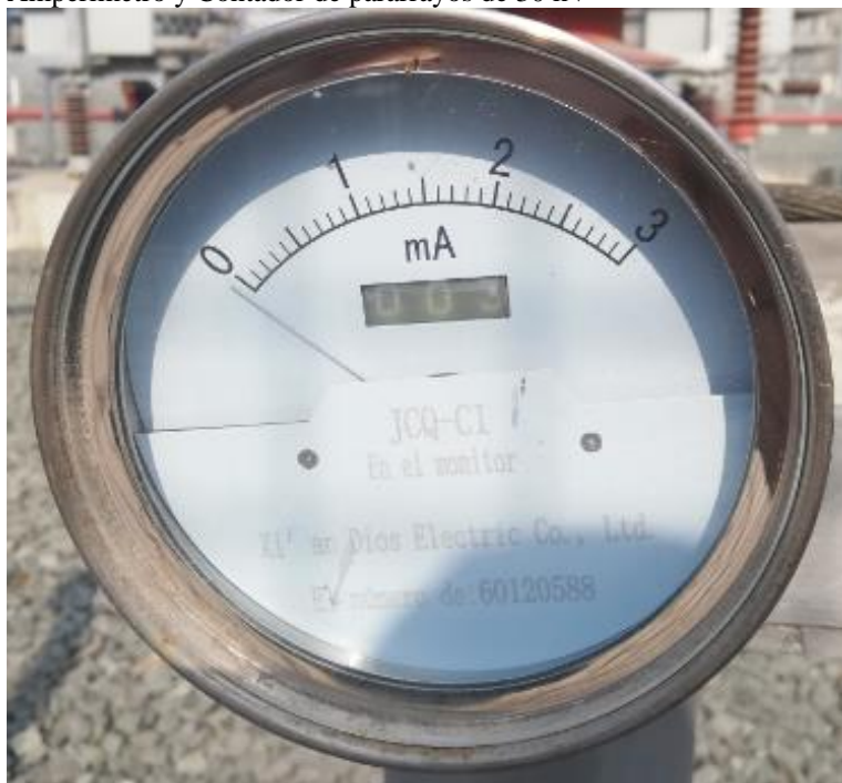
Figura 25 Amperímetro y Contador de pararrayos de 30 kV
