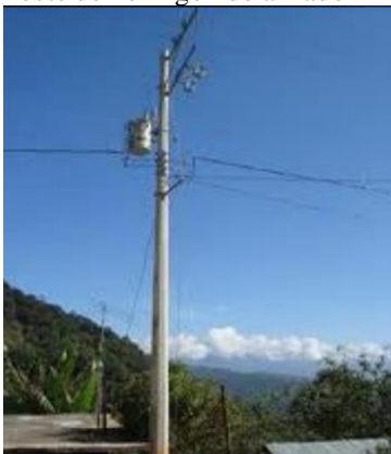
Figura 11: Poste de hormigón de armado
