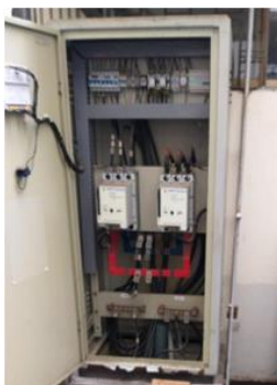
Figura 3.20: Tablero de control Elaborado por: Autor.
