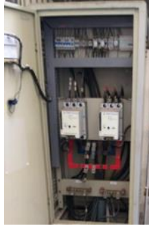
Figura 3.22: Tablero de control y monitoreo con la instalación de los dispositivos eléctricos y electrónicos. Elaborado por: Autor.
