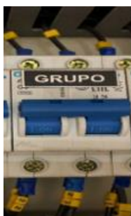
Figura 3.9: Interruptor General Automático (IGA). Elaborado por: Autor.
