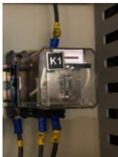
Figura 3.12: Señales eléctricas obtenidas del tablero de transferencia automática. Elaborado por: Autor.
