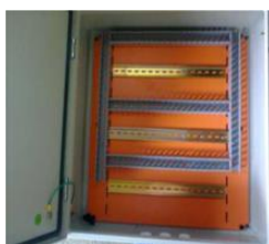
Figura 3.21: Tablero de control vista interior Elaborado por: Autor.
