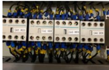
Figura 3.13: Contactores. Elaborado por: Autor.
