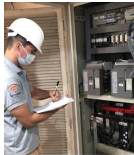
Figura 3.23: Tablero de control y monitoreo con su respectivo cableado y luces piloto en la parte externa de la puerta Elaborado por: Autor.
