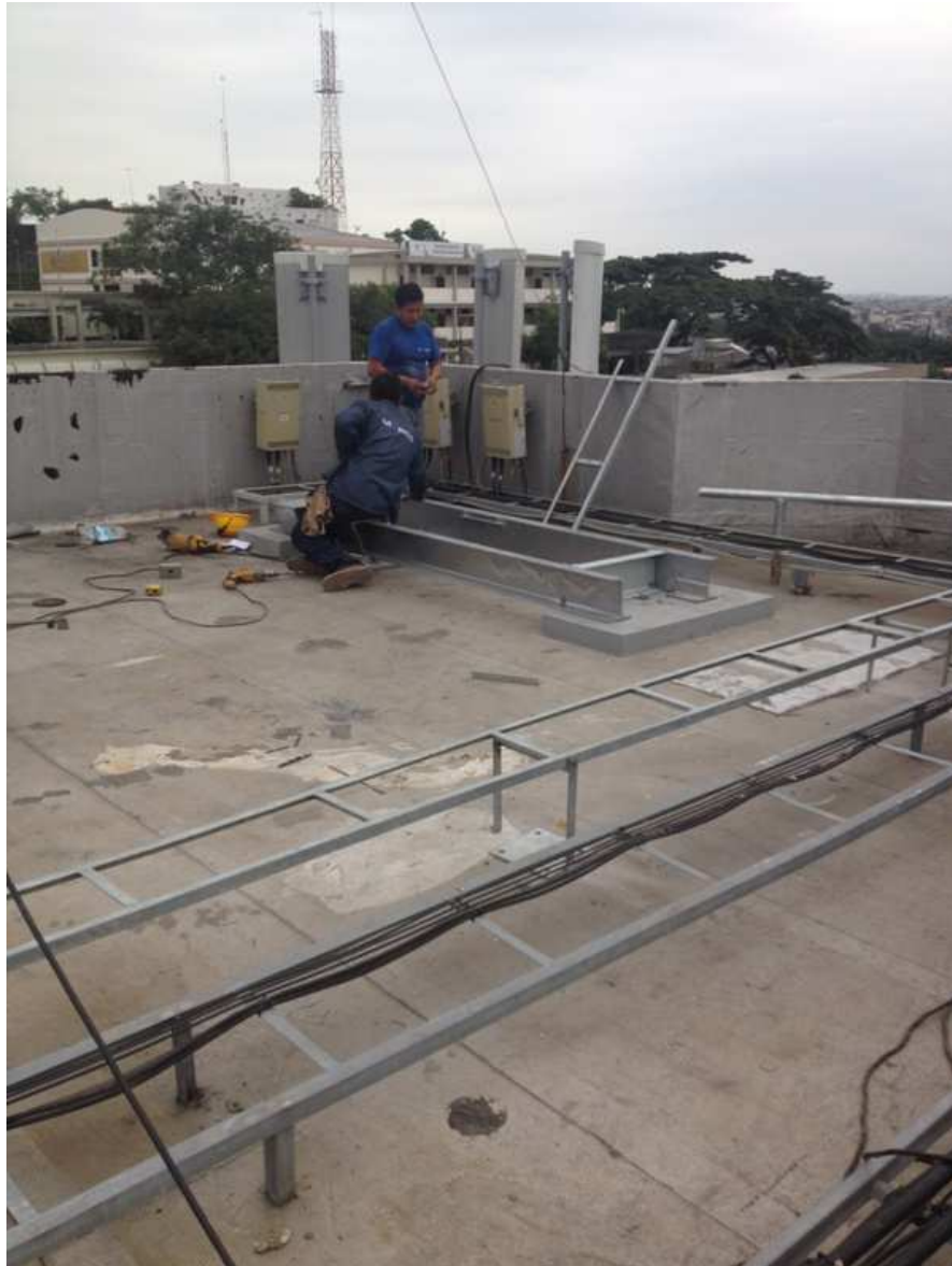
Instalación de la base para los equipos de la radio base de la CNT.
