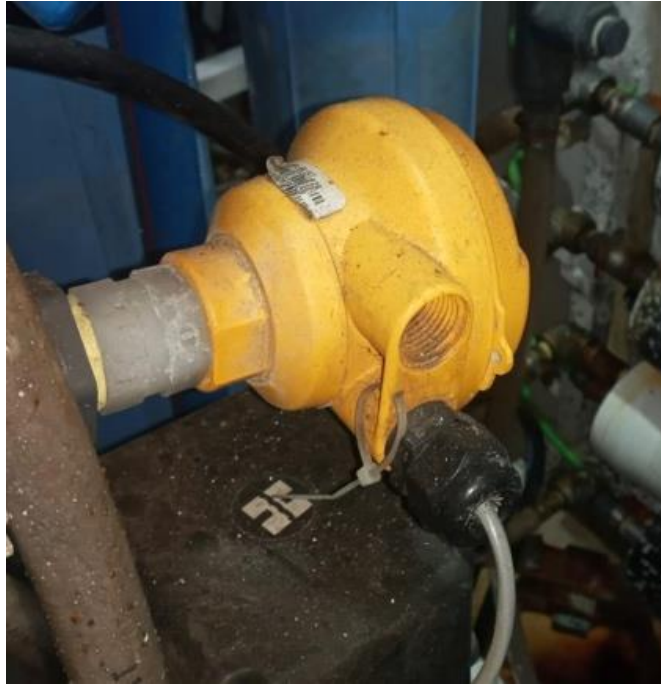
Figura 11 Salinómetro de la planta de purificación
