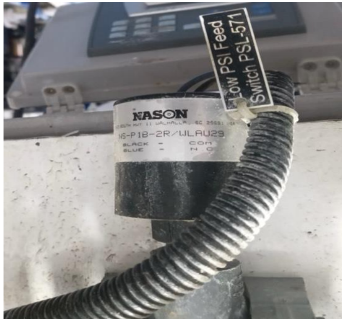
Figura 13 Sensor de presión de una planta de purificación
