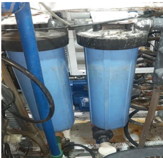
Figura 14 Filtros de una planta de purificación
