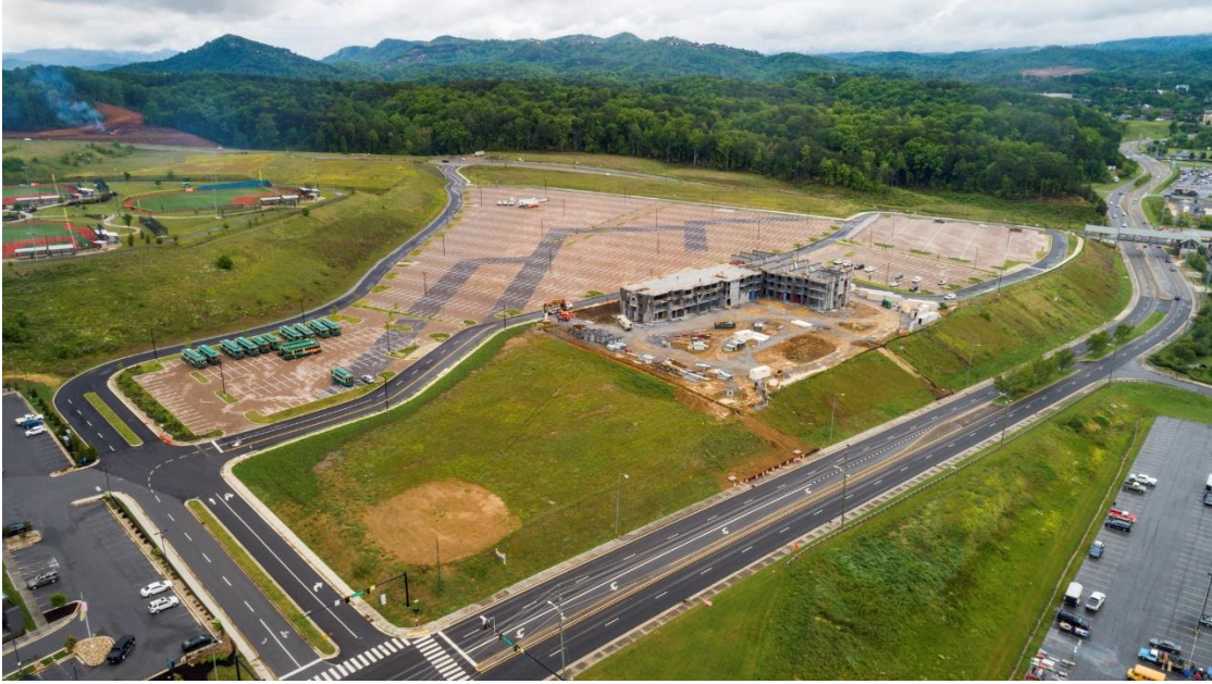
Ilustración 4. Parqueadero con pavimento permeable para centro de eventos, Pigeon Forge, Tennessee. Obtenido de (Gresham Smith, 2022)
