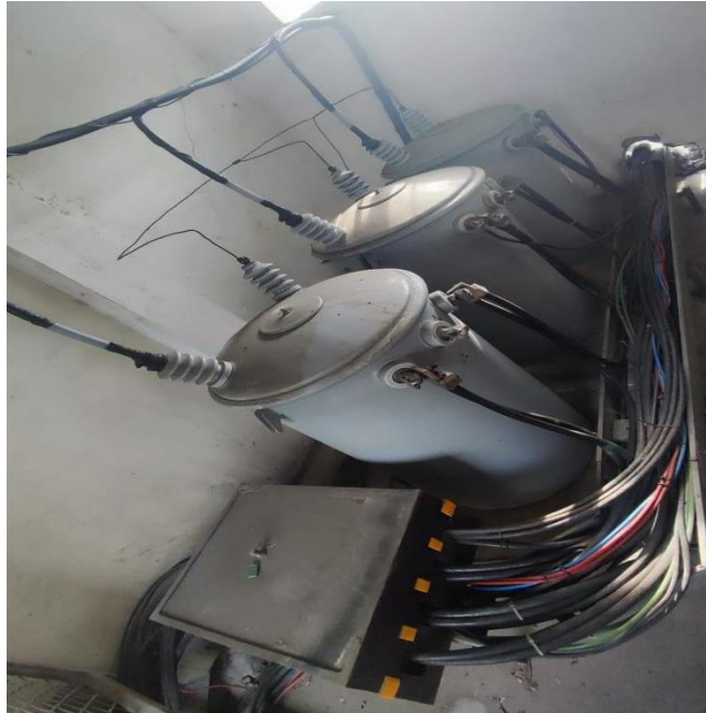
Figura 3. 2 Banco de transformadores de 3x100KVA de la FETD
