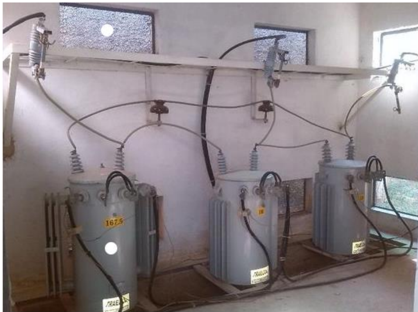
Figura 2. 1 Cuarto de Transformadores
