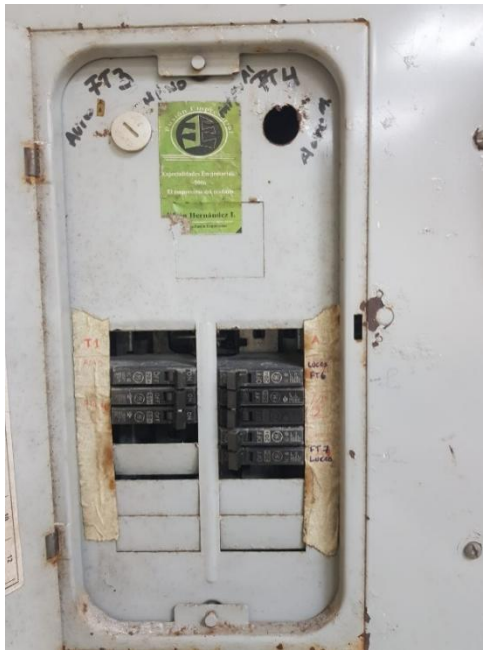
Figura 3. 9 Panel de disyuntores FT-6
