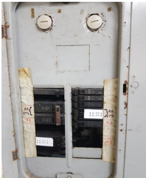
Figura 3. 10 Panel de disyuntores FT-8
