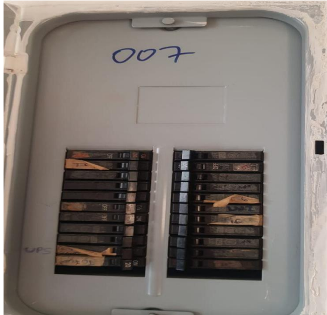
Figura 3. 6 Panel de disyuntores PB2 – 007 Administración
