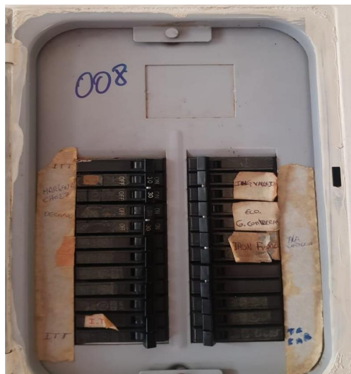
Figura 3. 5 Panel de disyuntores PB1 – 008 Administración
