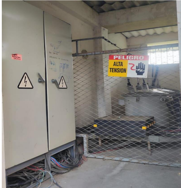
Figura 3. 3 Cuarto eléctrico de la FETD
