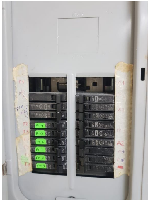
Figura 3. 11 Panel de disyuntores FT-4
