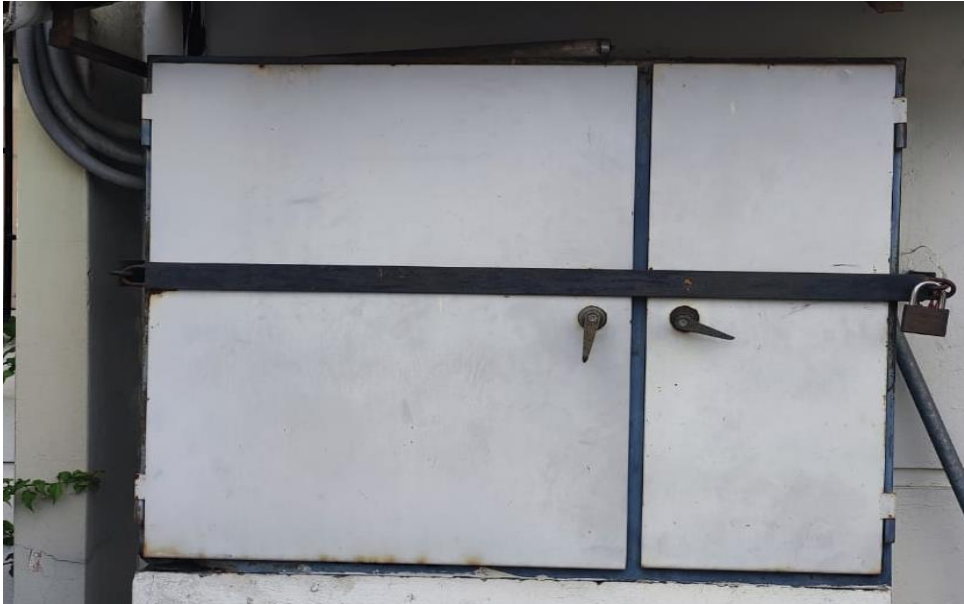
Figura 3. 8 Tablero de Distribución Auxiliar
