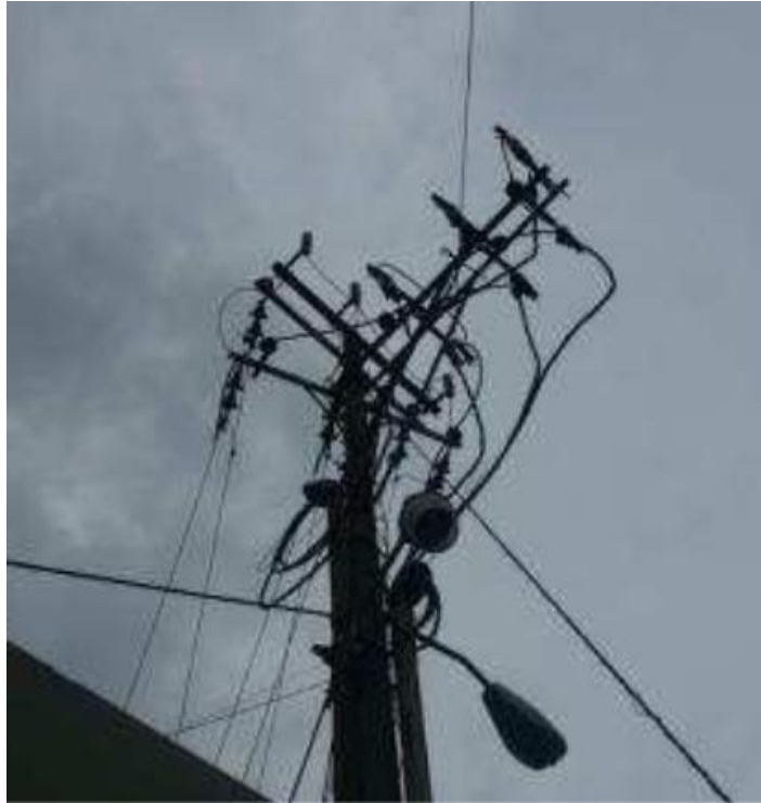
Figura 3. 1 Acometida de media tensión
