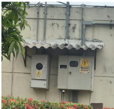
Ilustración 3.3 Cuarto de control (Tamayo D. F., 2023)
