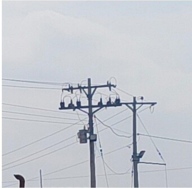
Figura 35 Equipos de medición en media tensión, Transformador de corriente y transformador de voltaje
