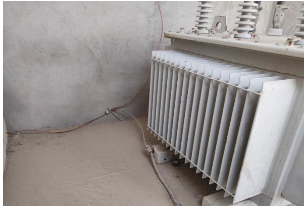
Figura 40 Puesta a tierra del transformador
