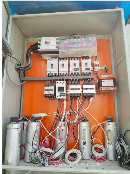
Figura 41 Banco de capacitor de 96 kVAR trifásico
