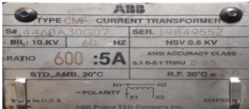
Figura 26 Placa característica Transformador de corriente
