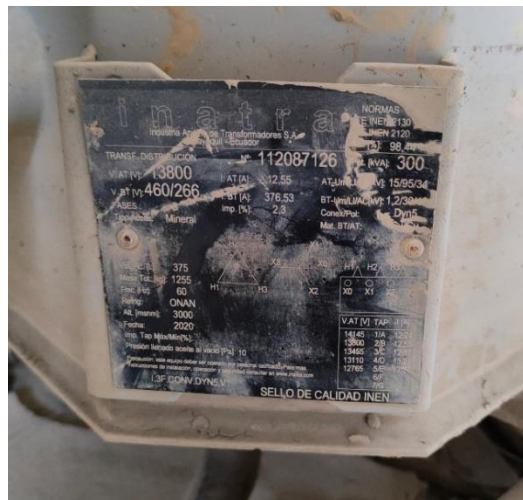
Figura 39 Dato de placa del Transformador de 300 kVA trifásico a voltaje de 13.8 kVA a 460 Volt
