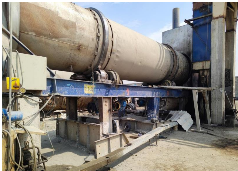
Figura 2. Maquina mezcladora de concreto
