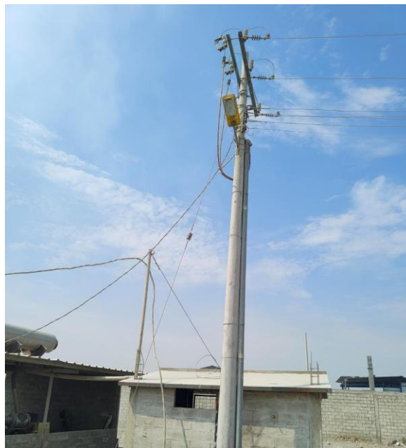
Figura 34 Acometida trifásica conectada a 13 800 Voltios
