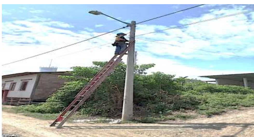
Figura 3.6 Revisión de Cables instalados en Poste
