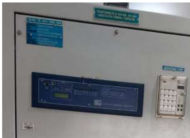
Figura 3.2 Relé de protección principal a 69 kv.
