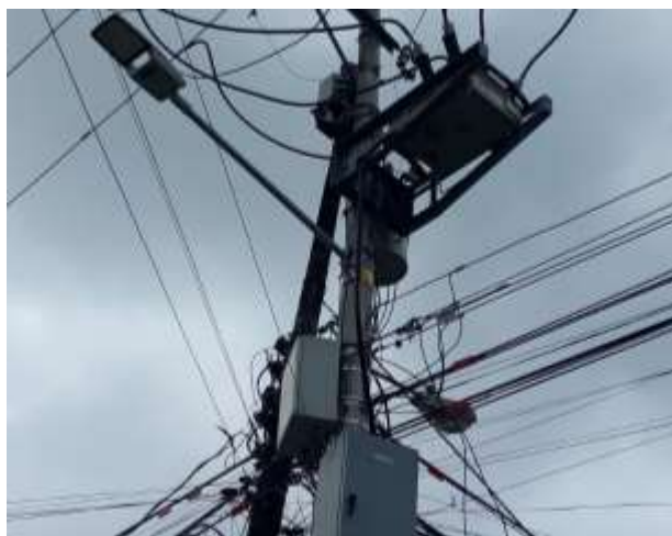
Figura 3.14 Reconectador de transferencia ubicado en el final del Alimentador.
