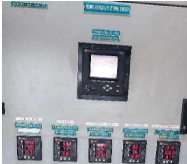
Nota: Equipo asignado de la subestación Terminal Terrestre. Foto tomada por el autor, 2024.
