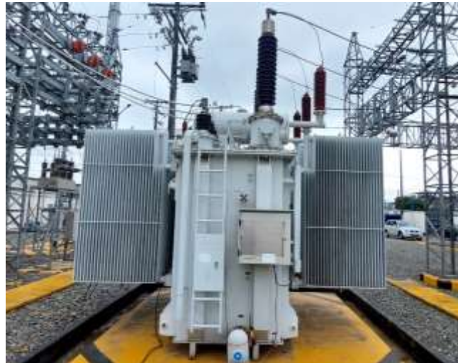
Figura 3.4 Transformador de Potencia de 20/25 MVA - 69/13.8 KV.
