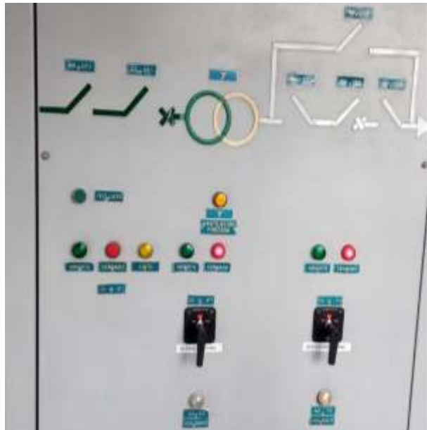
Figura 3.3 Tablero de control de los equipos de protección a 69 kv
