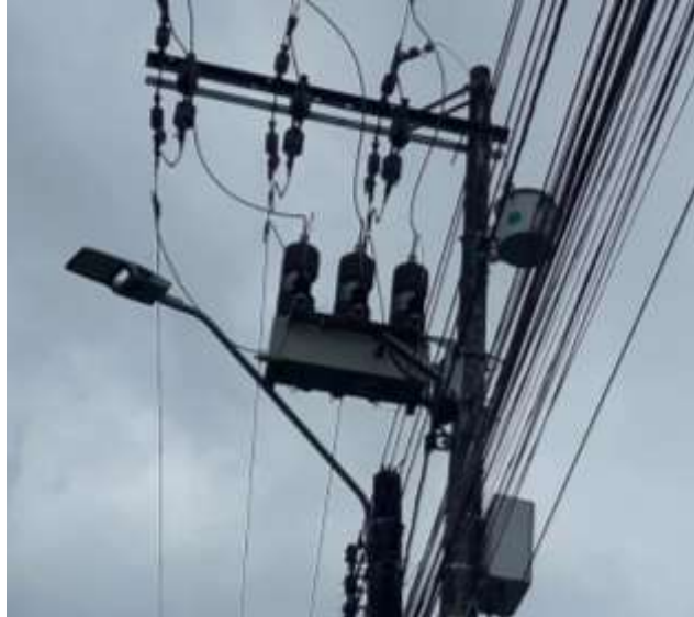
Figura 3.11 Reconector Trifásico de línea.
