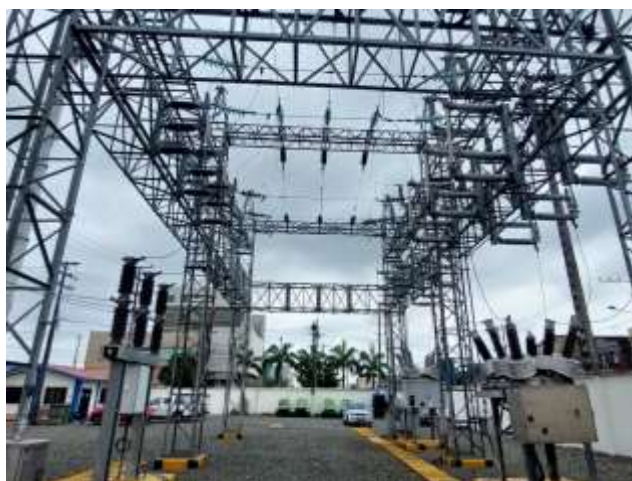
Figura 3.5 Vista del cuadro de maniobras a 69 Kv de la subestación.
