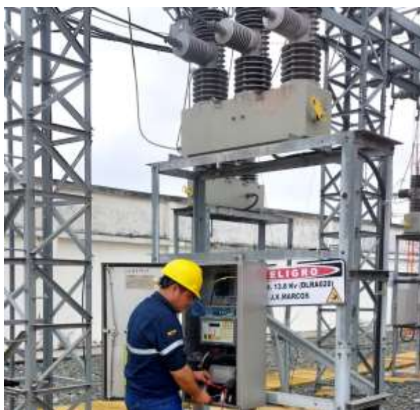
Figura 3.6 Revisión del tablero de control del reconectador de cabecera.
