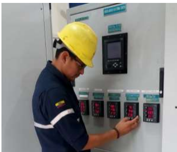
Figura 3.8 Revisión de parámetros de los tableros principales en la cabina de control de la Subestación.
