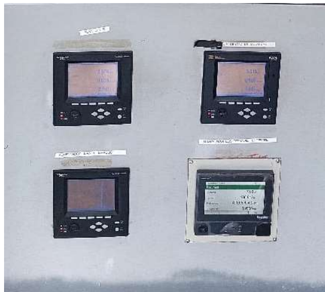
Figura A4 Tablero de control de parámetros de los alimentadores derivados de la subestación Terminal Terrestre #2
