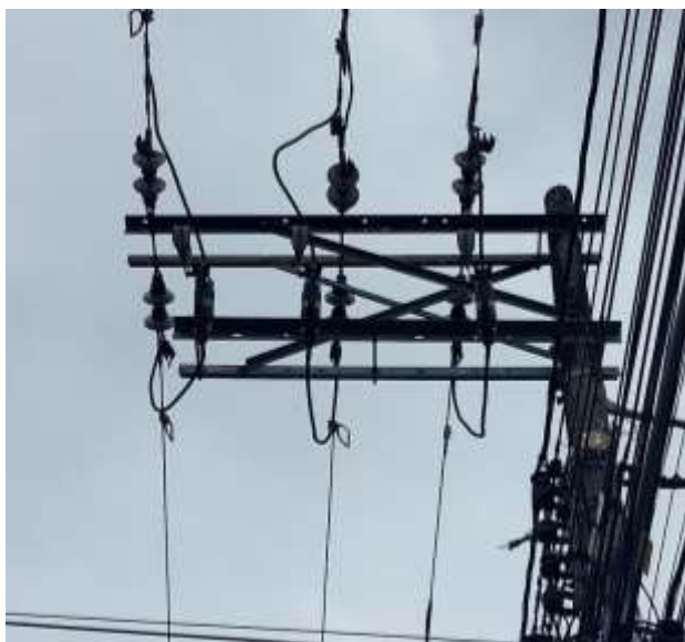
Figura 3.12 Seccionadores tipo barras instalados en el Alimentador.
