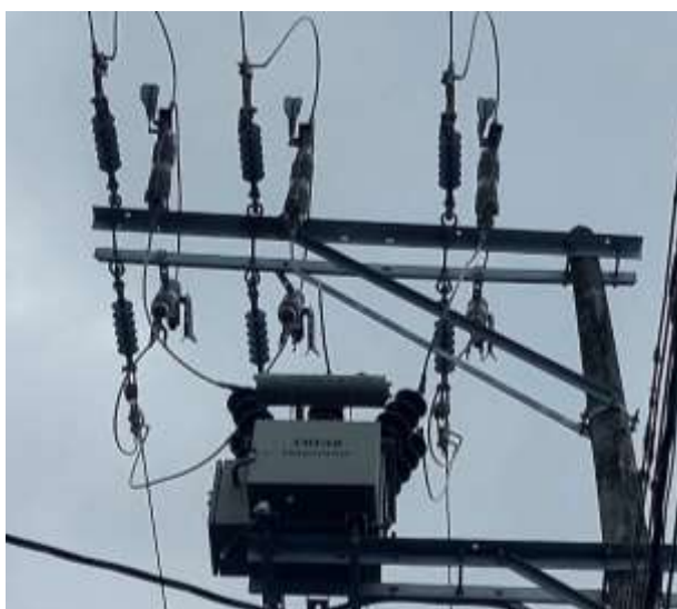
Figura 3.9 Equipo de medición en media tensión Transformix.
