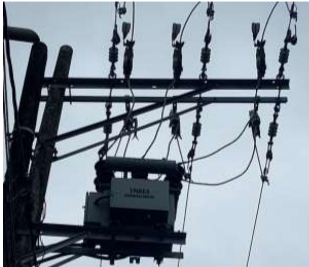
Figura 3.13 Equipo de medición instalado a la mitad del Alimentador.
