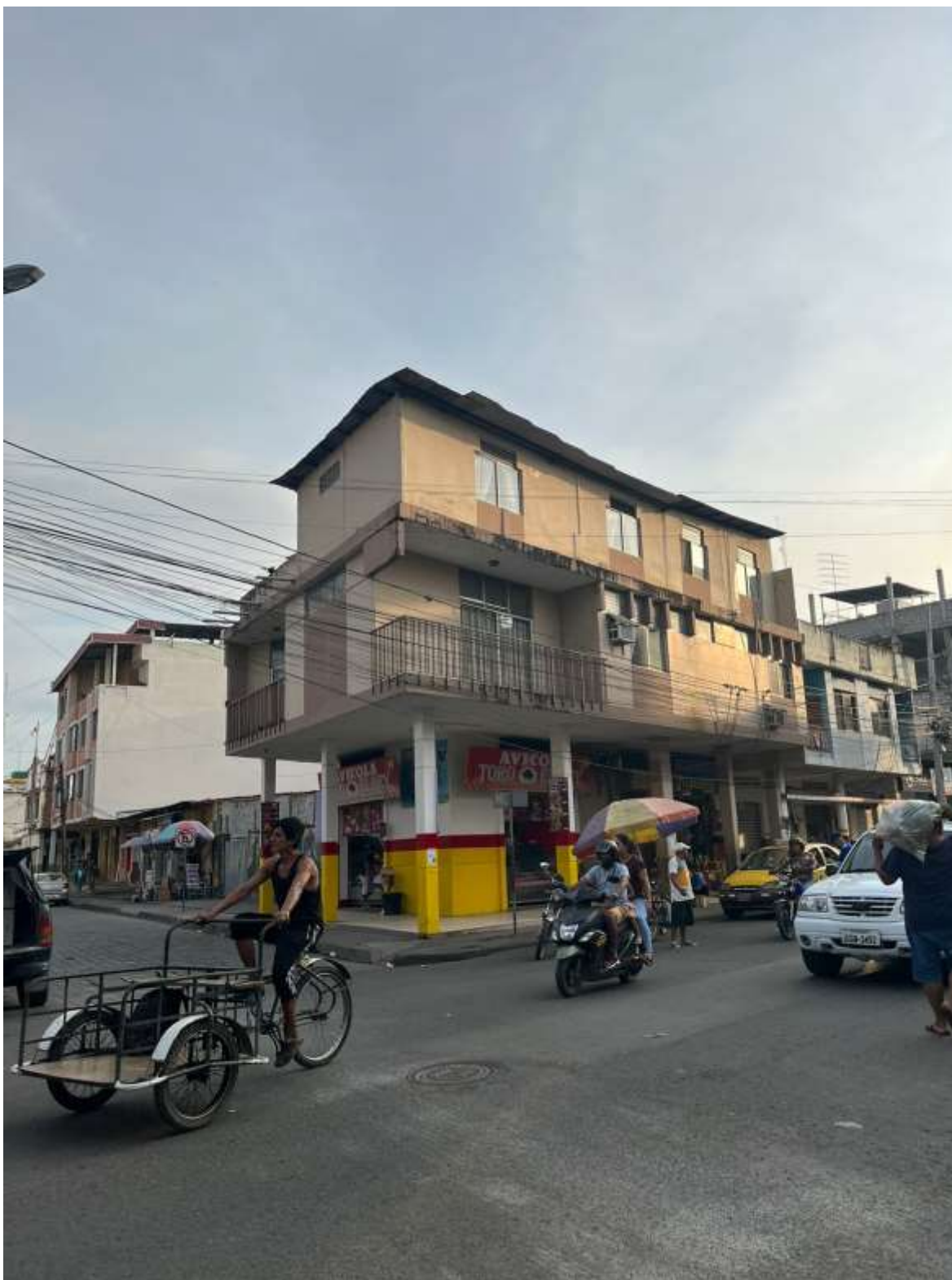
Ilustración 56. Estructura en las calles Rocafuerte y 24 de mayo con irregularidades verticales de adición de un piso y piso débil en planta baja. Fuente: Elaboración propia.
