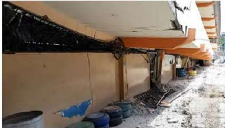
Ilustración 12. Comportamiento de un sistema estructural con columna corta. Tomada de (Ministerio de Desarrollo Urbano y Vivienda, 2020).
