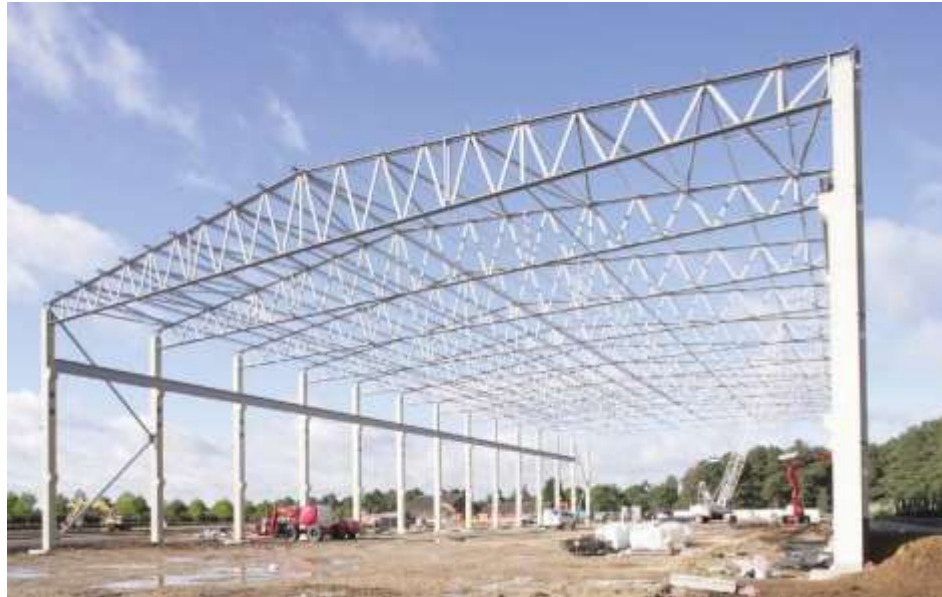
Ilustración 30. Pórtico de acero laminado en frío (S3). Tomado de (Montajes, Ingeniería & Construcción. MIC S.A.S, 2023).
