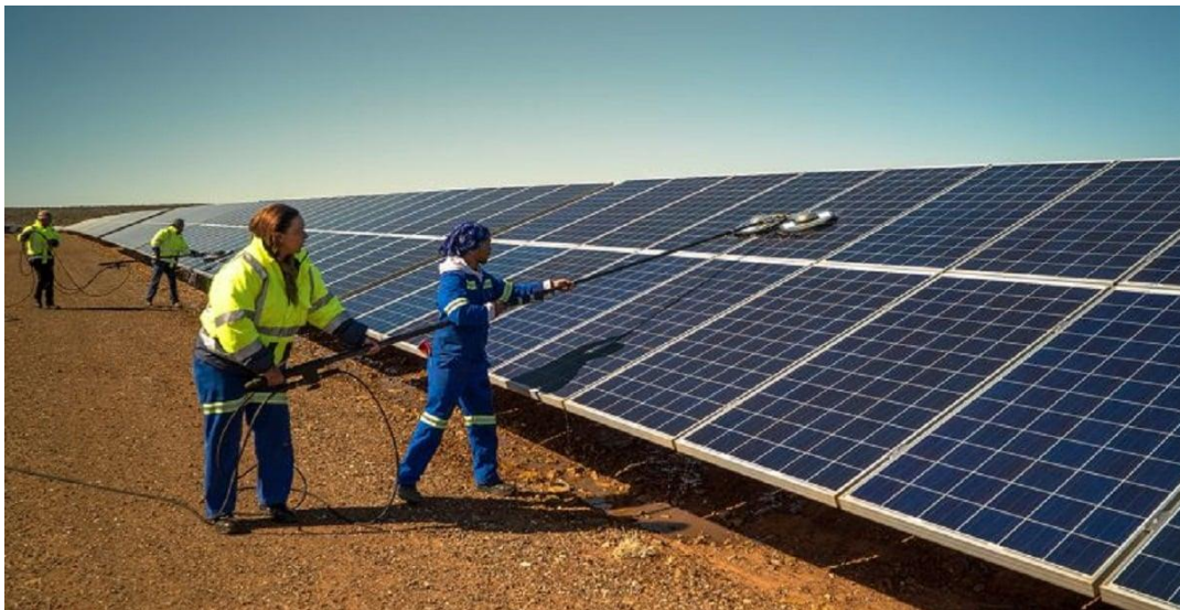
Figura 21. Mantenimiento preventivo sistema fotovoltaico
