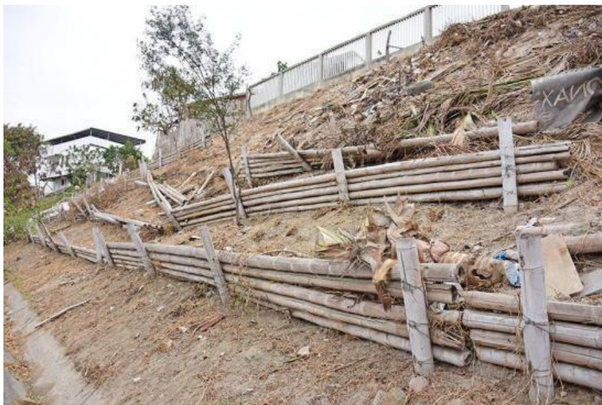
Figura 40. Talud sin la correcta protección en la ciudad de Manta, Manabí.
