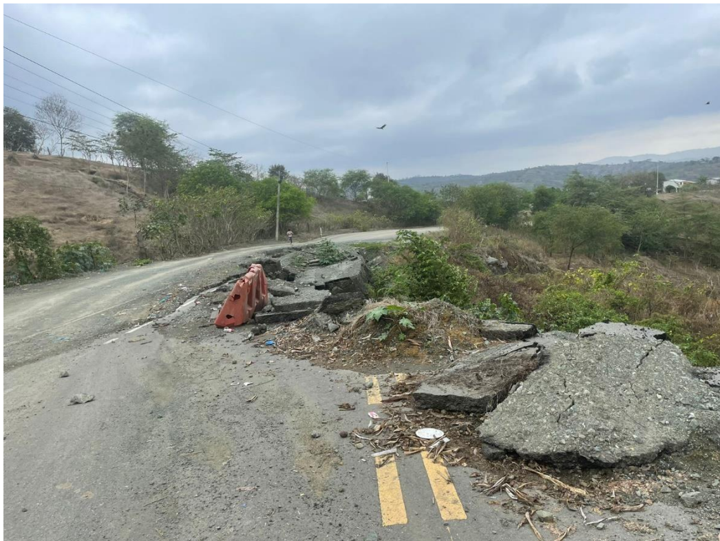
Figura 9. Deslizamiento en vía Tosagua - Bahía de Caráquez.
