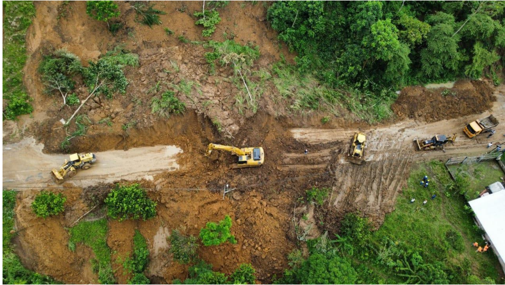
Figura 5. Deslave de gran magnitud producto de las lluvias en la zona en la vía Chone-Flavio Alfaro.
