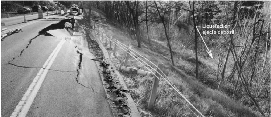
Figura 38. Fallo del terraplén de la carretera durante el terremoto M 5.0.
