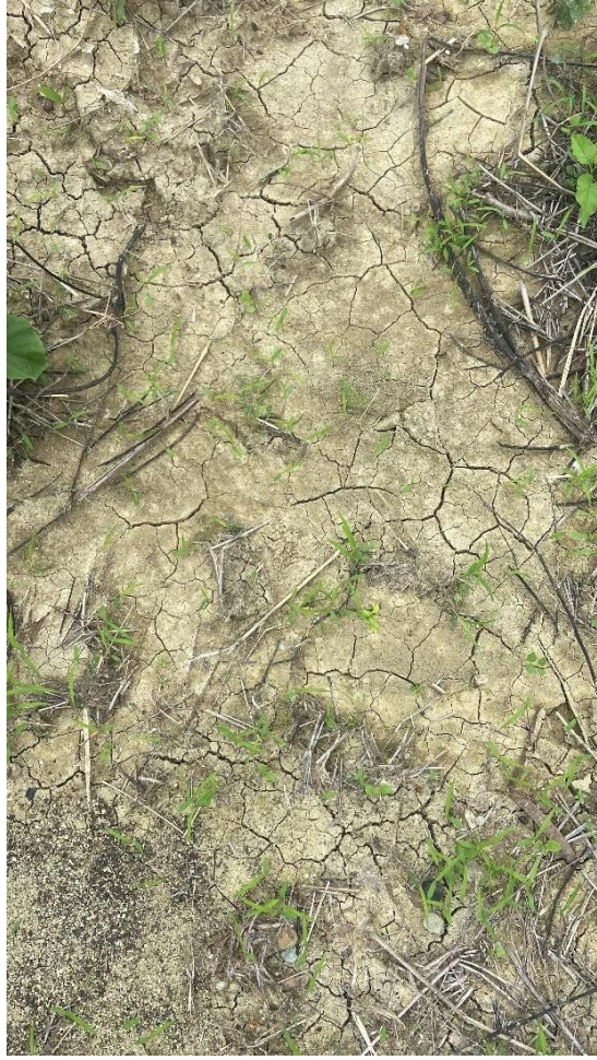
Figura 62. Talud con arcillas expansivas.
