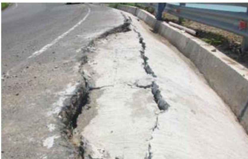
Figura 7. Desplazamiento y asentamiento de espaldón y cuneta.
