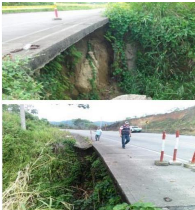
Figura 6. Colapso del espaldón de la calzada y cuneta en vía El Carmen – Sto. Domingo.
