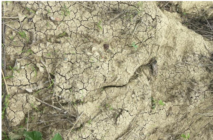
Figura 63. Talud de carretera con arcillas expansivas.
