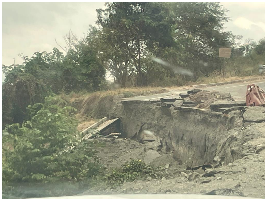
Figura 8. Deslizamiento en vía Tosagua - Bahía de Caráquez.
