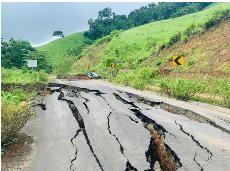
Figura 1. Vía destruida por fuertes lluvias invernales en Jama, Manabí
