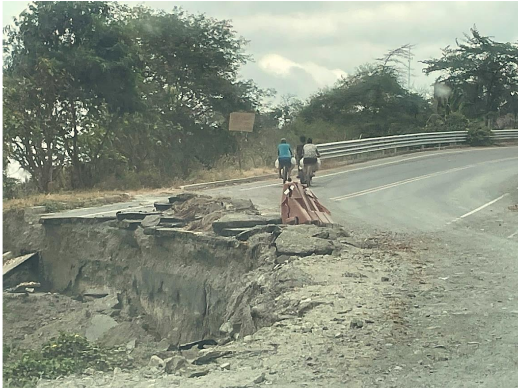
Figura 36. Deslizamiento del terraplén de la vía en la Provincia de Manabí.
