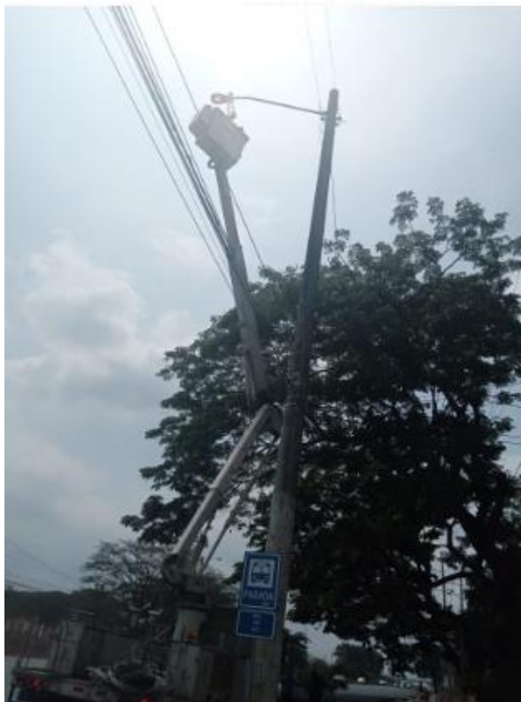
Figura 30 Poste de Hormigón armado de 18 metros
