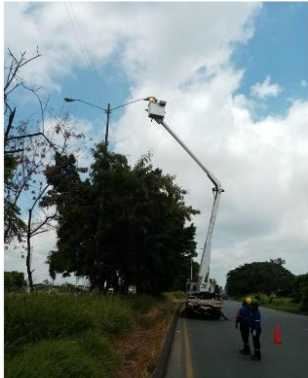
Figura 26 Poste con Luminarias de Sodio en Vía a la Costa.
