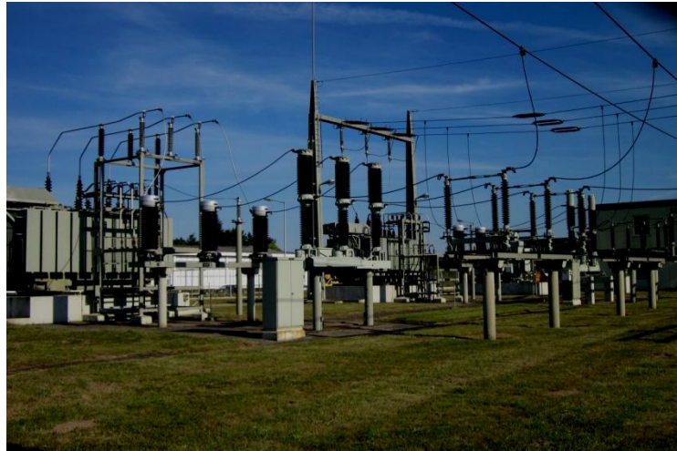
Figura 10 Transformadores de Distribución Fuente: (Arias F. L., 2022).
