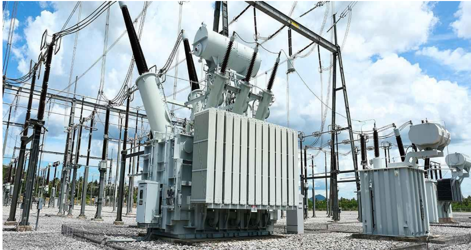
Figura 12 Transformadores Elevadores Fuente: (Globe Core, 2021).
