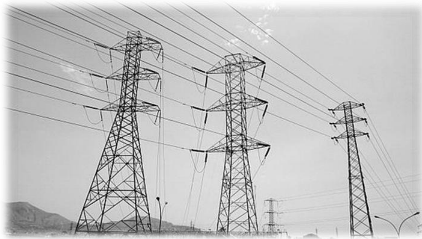
Figura 17 Líneas de Transmisión Fuente: (Arias, González, & Álvarez, 2023).
