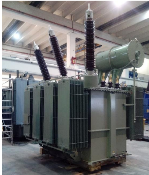
Figura 2.5. Transformador de poder 69/13.8 kv
