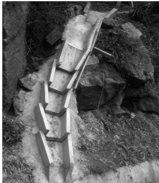
Figura 68. Torrentera en gradería
