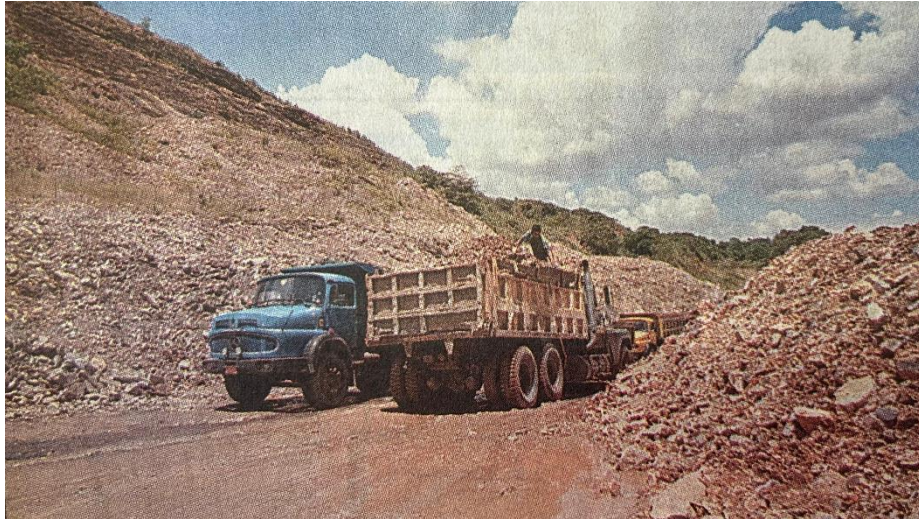
Figura 3. Volquetas del Municipio realizando trabajos de desalojo del material deslizado
