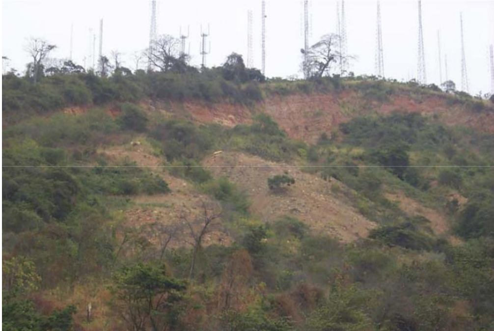
Figura 34. Deslizamiento de material coluvial en Cerro Azul: lutitas y limonitas de la formación Guayaquil, fuertemente meteorizadas
