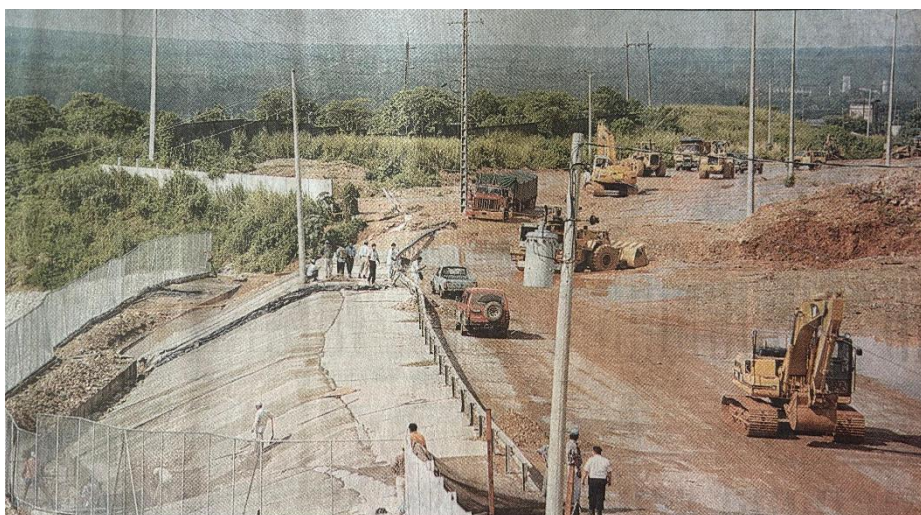
Figura 7. Personal evacuando el material del Cerro Azul, se presenta el muro fisurado tras el primer deslave
