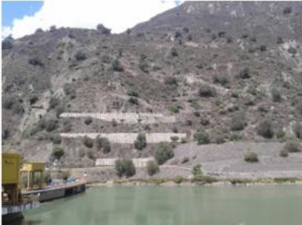
Figura 89. Vista frontal del Derrumbe N#5, ubicado sobre el estribo derecho de la presa de Tablachaca
