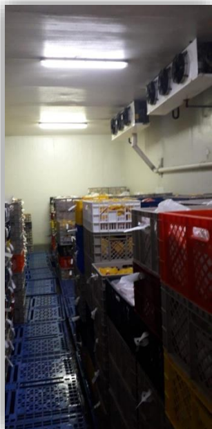
Interior de cámara de frío #2
