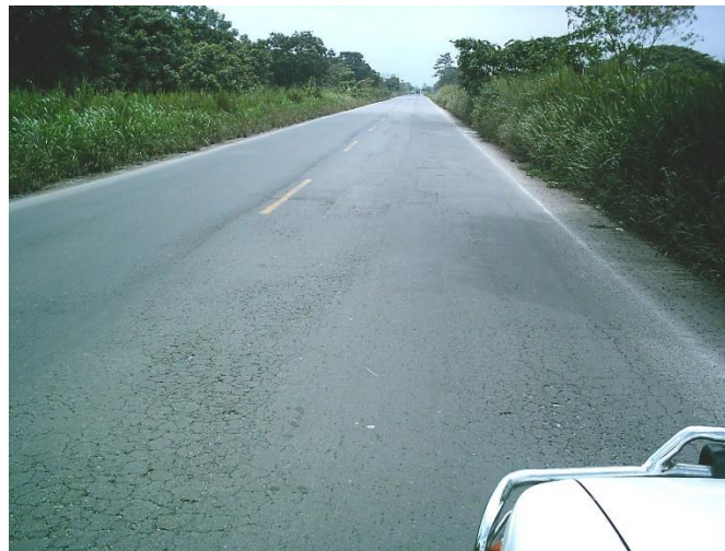
Figura 2. Falla tipo piel de cocodrilo
