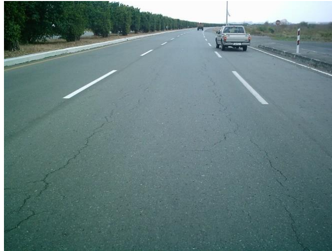
Figura 3. Grietas descendentes en su etapa inicial
