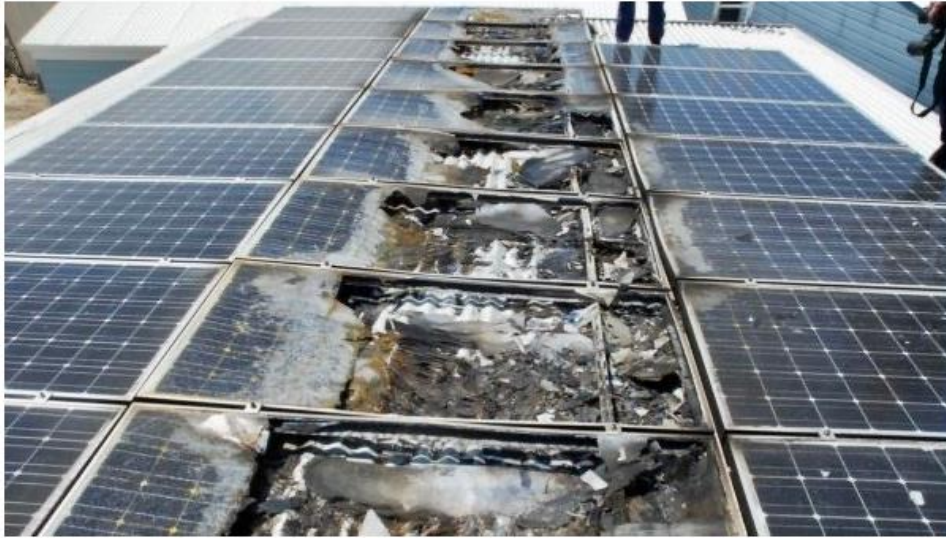
Figura 2.56. Paneles solares incendiados Fuente: https://engi.co/incendios-paneles-solares/
