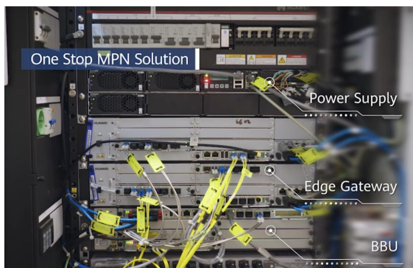
Figura 11 equipamiento por cada estación radio base
