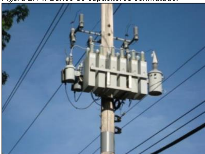
Figura 2.14: Banco de capacitores conmutado.
