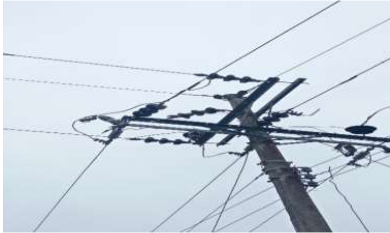
Imagen 17 Seccionador y puente media tensión Roto
