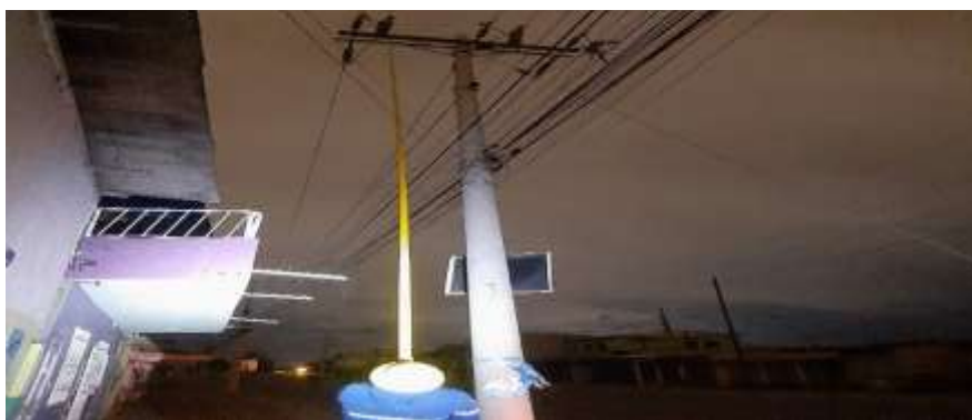
Imagen 25 Maniobras Para Realizar Desconexión
