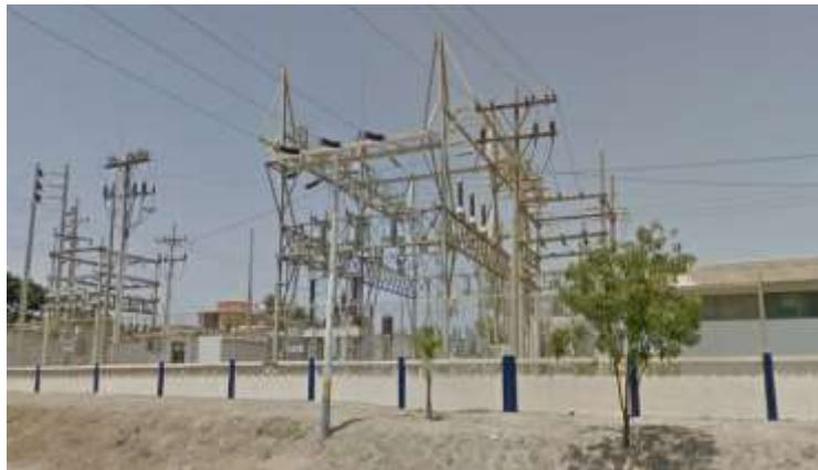
Imagen 3 Ubicación: Subestación La Libertad 13.8 Kv
