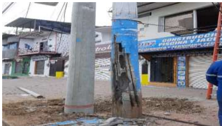
Imagen 21 Inspección Postes En Mal Estados
