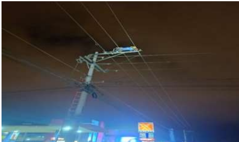
Imagen 18 Puente Media Tensión Roto
