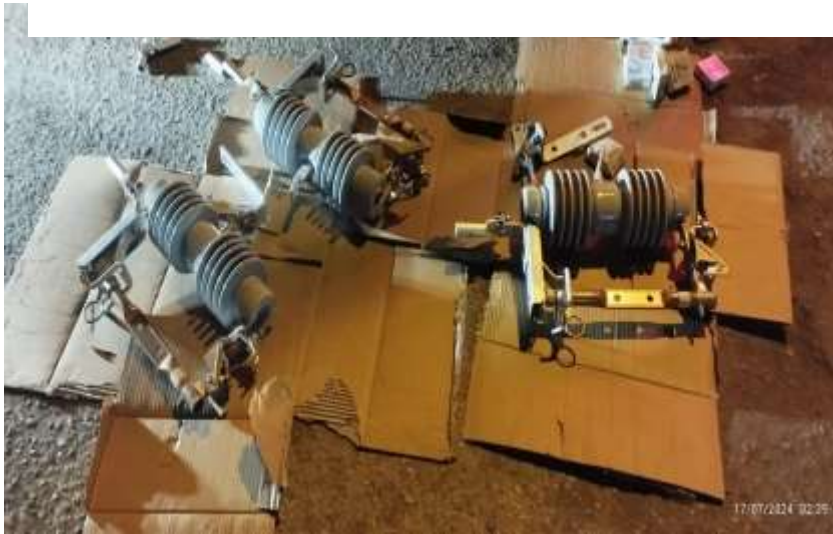
Imagen 29 Equipos De Protección Seccionadores
