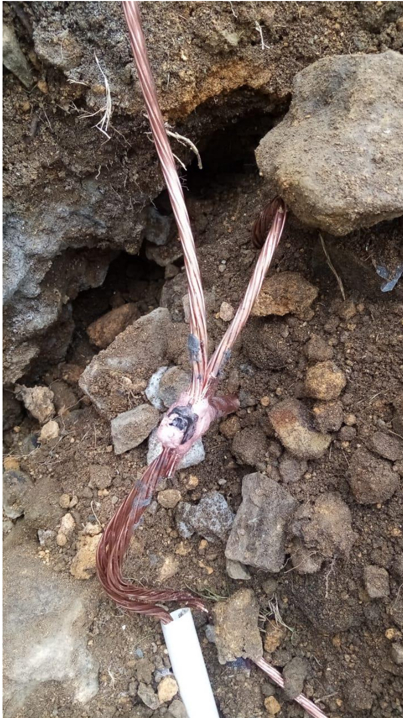
figura 3-4: Conductor desnudo del sistema de puesta a tierra
