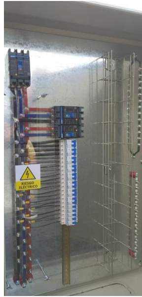
figura 4-10: Tablero de distribución principal trifásico
