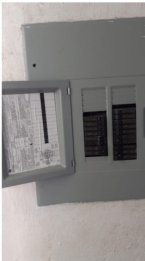
figura 4-11: Panel monofásico existente
