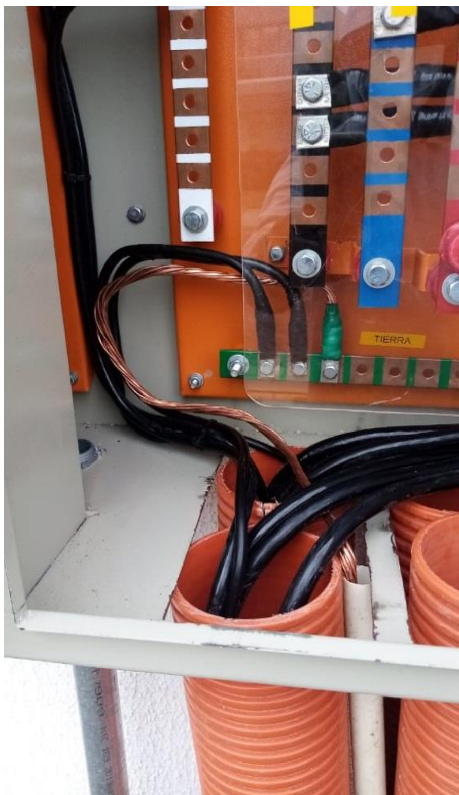
figura 3-3: Conductor aislado conectado a la barra del sistema de puesta a tierra.
