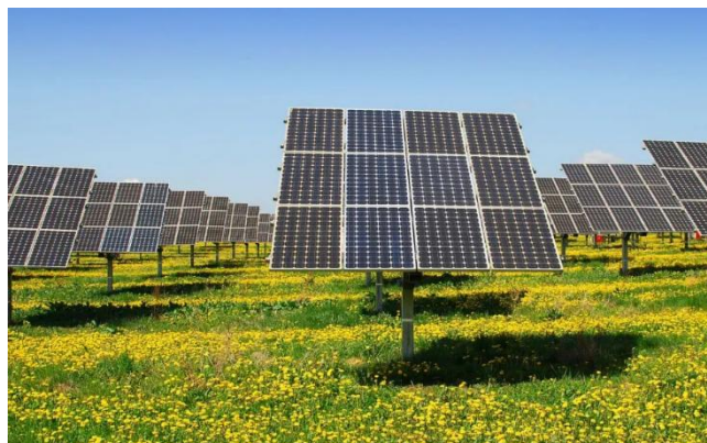
Figura 12: Módulo fotovoltaico Fuente: (Energía, 2022)
