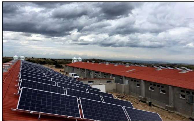
Ilustración 1 Instalación fotovoltaica en granja porcina
