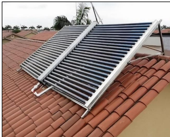
Ilustración 3 Sistema de colector solar térmico
