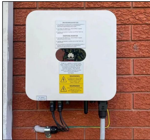
Ilustración 6 Inversor fotovoltaico montado sobre pared
