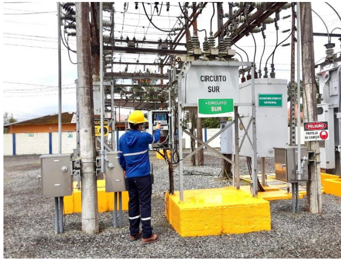
Figura 8. Monitoreo de los circuitos.
