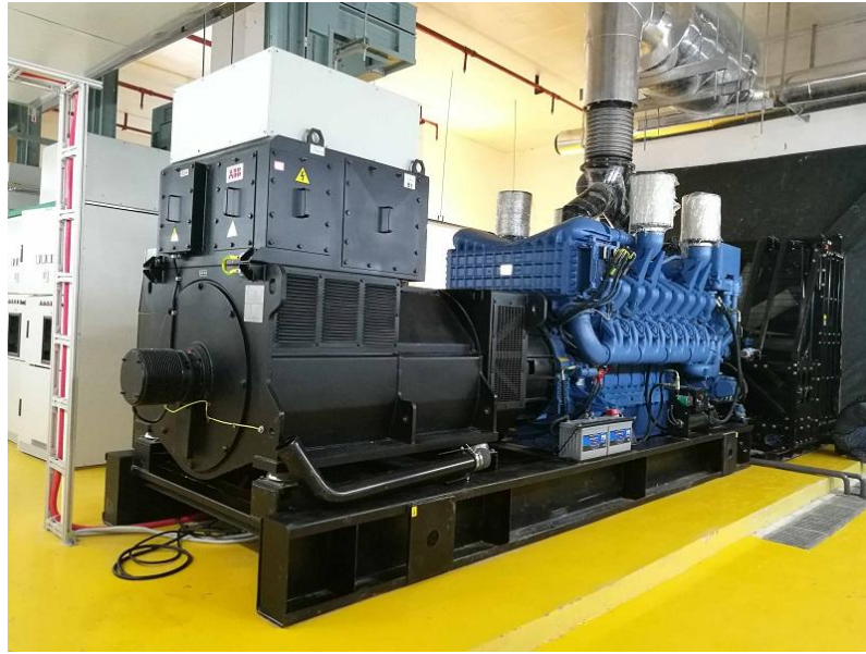
Figura 14. Generador a diésel
