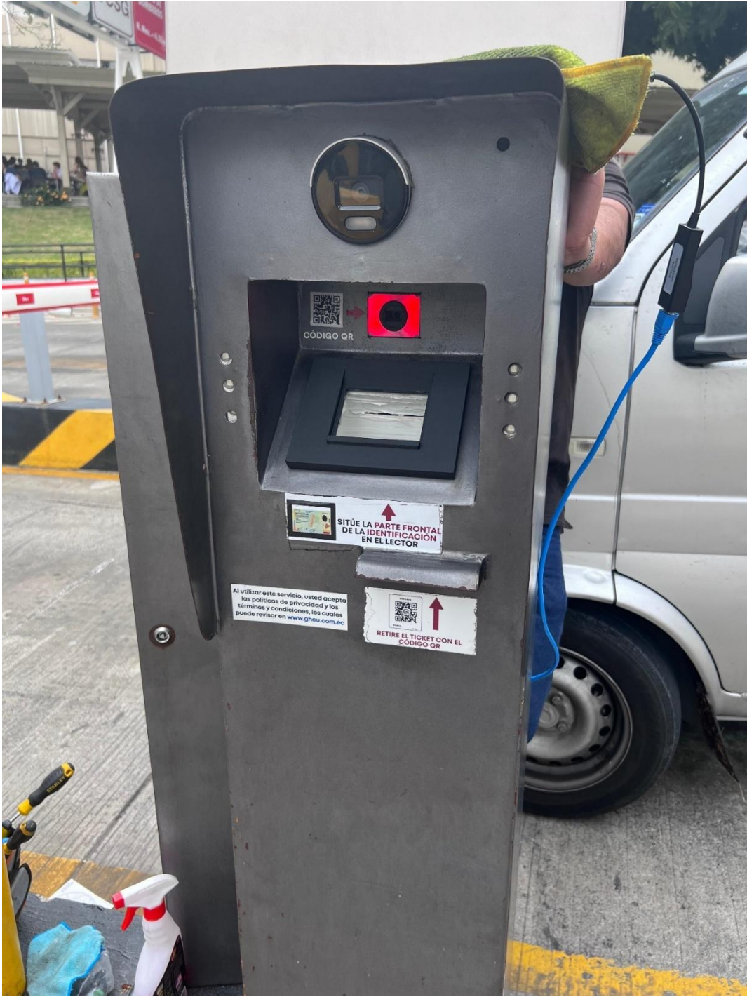
Anexo 8. Panel frontal del equipo dispensador y lector QR en operación.
