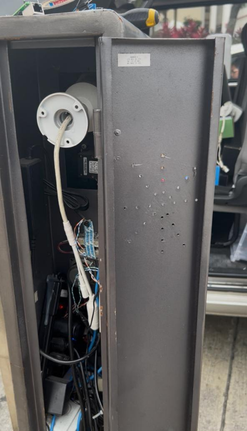
Anexo 7. Vista interna del gabinete del módulo de control con cableado y componentes eléctricos.
